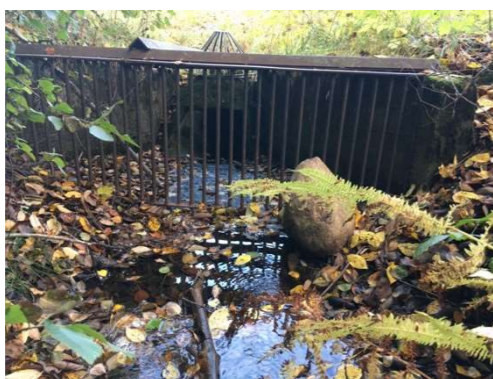
Melbybekken i rør
