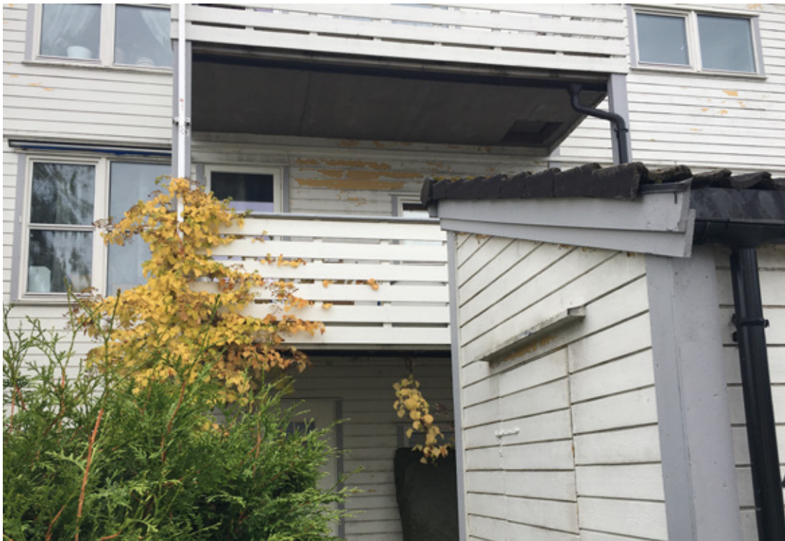
Figur 7. 10. Bebyggelse i området deltakerne bor i. Maling på småblokker som flasser av og viser frem tidligere gulmaling.
