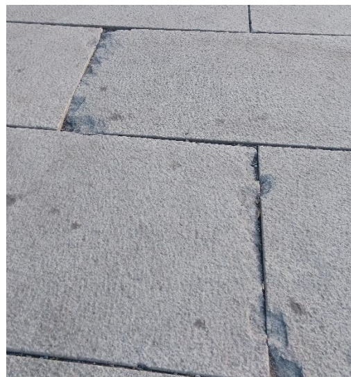
Figur 27 Avskalning på hjørner. Foto: Stian Lilletveit (2022, april 30)
