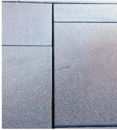
Figur 31 Forskyvninger i dekket p.g.a. manglende fugesand. Foto: Stian Lilletveit (2022, april 30)
