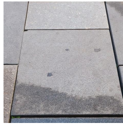
Figur 30 Forskyvninger i dekket p.g.a. manglende fugesand. Foto: Stian Lilletveit (2022, april 30)
