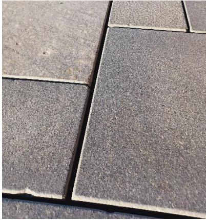
Figur 32 Manglende fugemasser. Foto: Stian Lilletveit (2022, mars 11)
