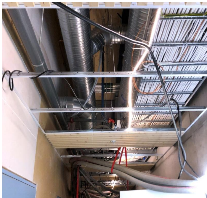
Figur 19. Tekniske installasjoner i taket. Foto: Bente Melkevik
