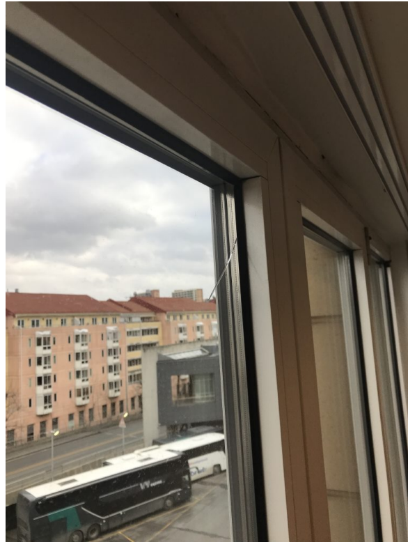
Figur 31: Glassfelt med sprekk , (Tatt på befaring 28. februar 2022)
