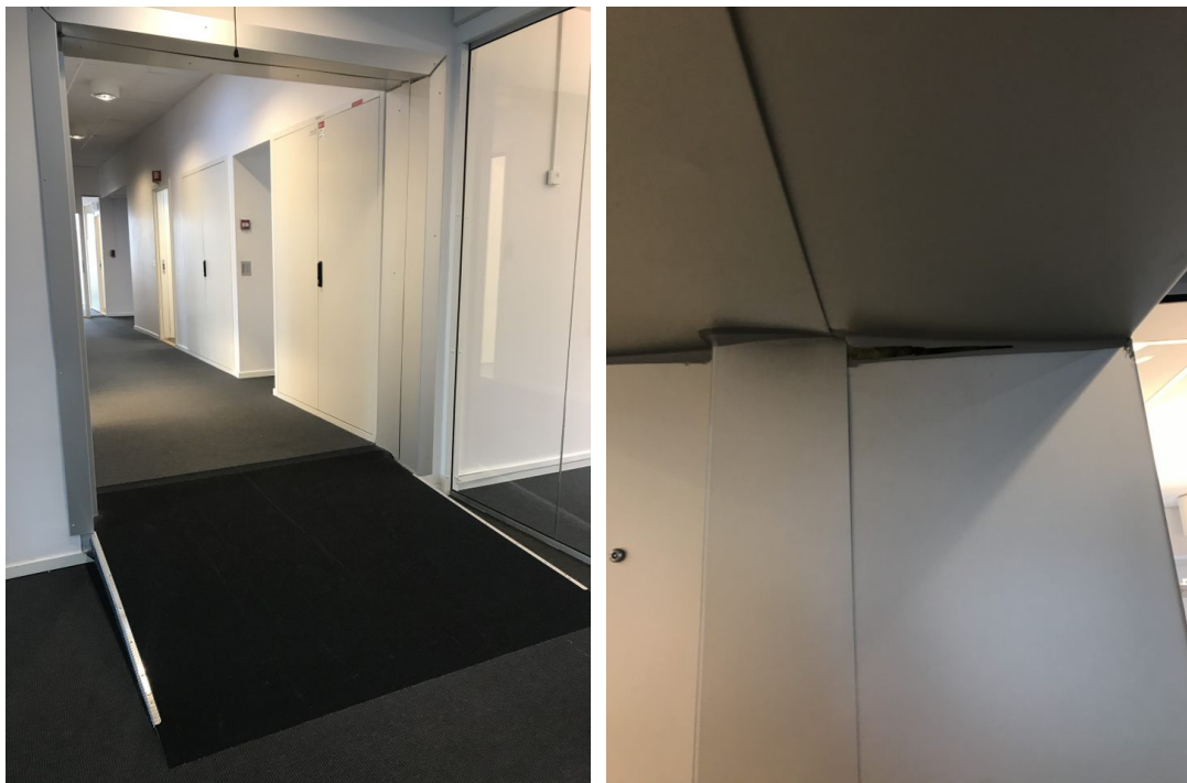
Figur 24: Setningskader i østlig del av Galleri Oslo, (Tatt på befaring 28. februar 2022)
