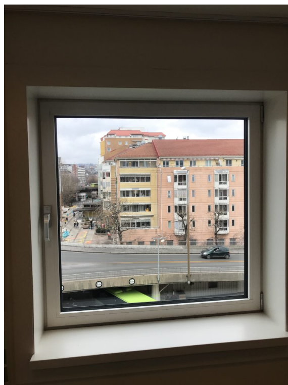
Figur 29: Hengslet vindu mot bussterminalen, (Tatt på befaring 28. februar 2022)
