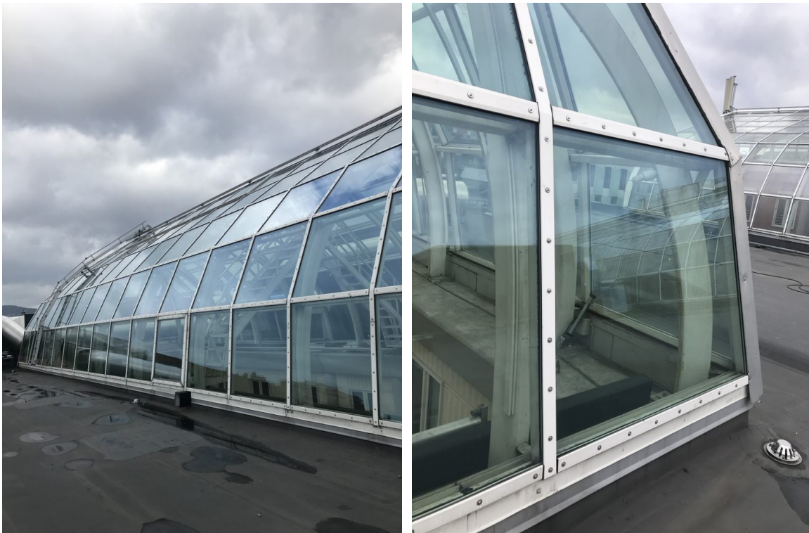
Figur 35: Glasskuppel på tak i østlige del av bygget, fra utsiden , (Tatt på befaring 28. februar 2022)
