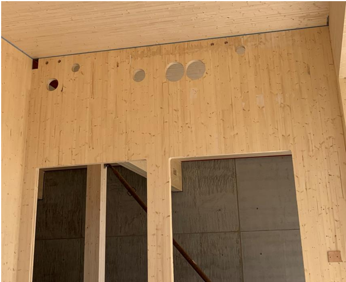
Figur 1: MT-elementer kommer levert til byggeplass med utsparinger til tekniske fag, dører og vinduer
