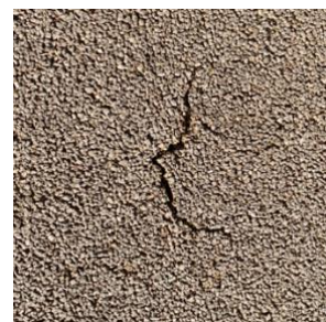
Figur 6: Oppsprukket korkdekke. Foto: Helene Hofmann
