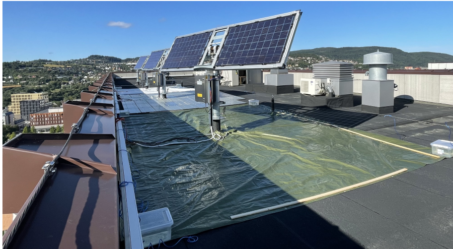
Figur 3.3: PV 4 under oppsett 1. Stativet har en grønn presenning under seg som holdes nede av plastbokser med vann. Bildet er tatt fra øst mot vest.
