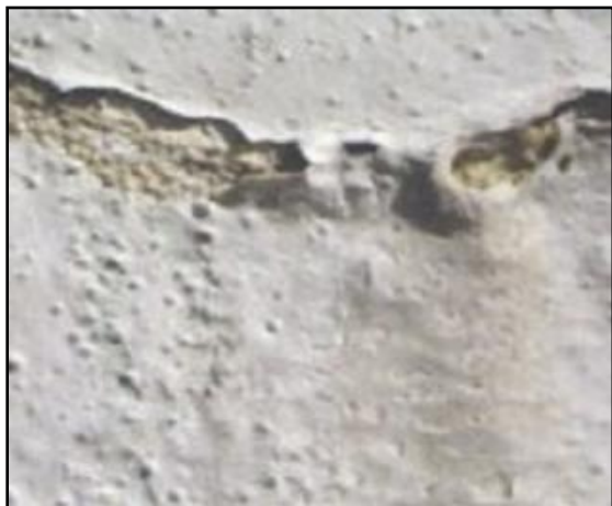
Figur 13: Fuktinfiltrasjon fra fundamentet som danner saltutslag på utsiden av murveggen. ( http://www.dicaseiras.com/2010/02/10/guia-completo-como-combater-eliminar-prevenir-humidade/ )
