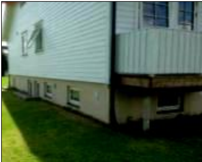
Figur 15: Kjellerens ventilering kan foregå gjennom avtrekksvifter, luftventiler eller vinduer; og til oppvarming kan brukes div. typer varmeapparater.
