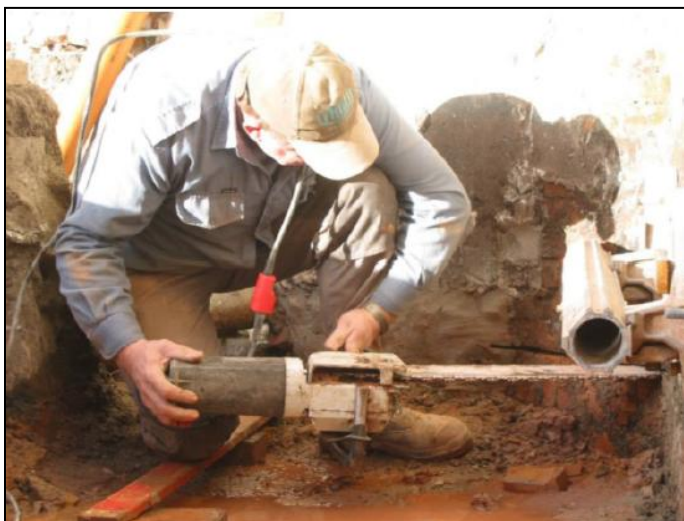
Figur 30: Skjæringsprosessen som foregår manuelt med elektrisk sag. (Sintef, Utbedring av fuktskadede kjelleryttervegger)
