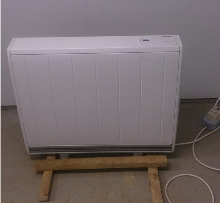
Figur 13: Dimplex Quantum QM-100 plassert midt i rommet. Ovnene er plassert på et stativ i tre, da det ikke var mulig å montere ovnen direkte på veggen.
