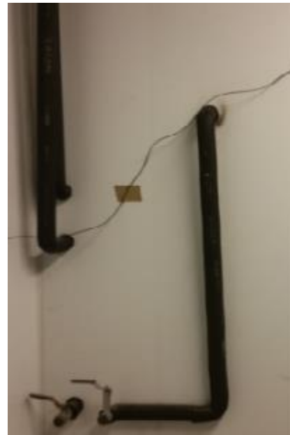
Figur 6: På bildet vises deler av de isolerte vann-rørene som går gjennom rommet.
