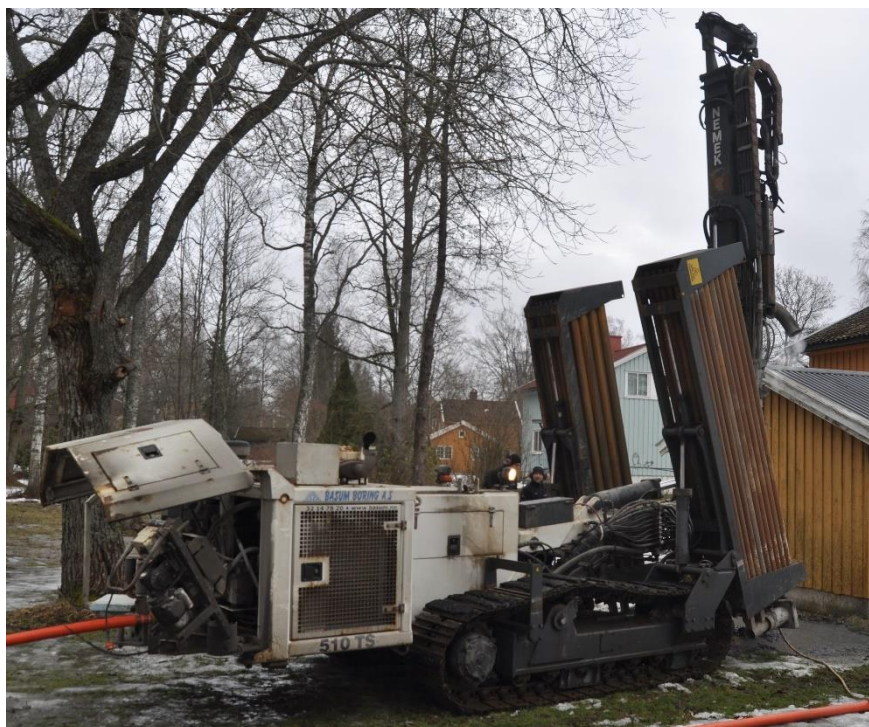
Figur 28: Borerigg benyttet for boring av de to energibrønnene bak energilaben ved NMBU. Trykkluft fra luftkompressoren tilføres via det oransje røret.
