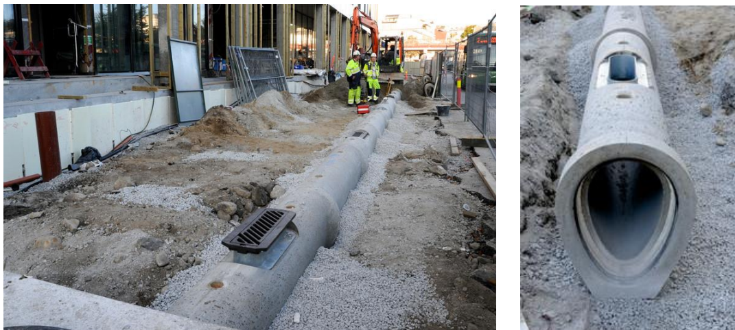
Figur 2.8.21. Bilder av Qmax storm ferdig montert i grøften under utbyggingen av støperikvartalet (Skjæveland Cementstøperi AS, 2015).
