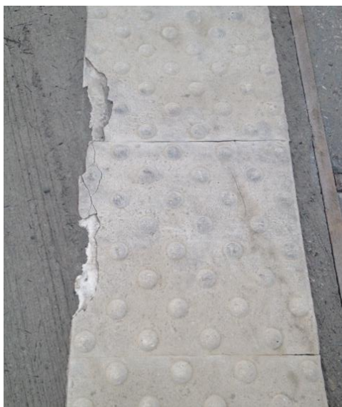
Figur 22 Ledelinjer av termoplastikk. En ulempe med disse er at de blir raskt slitte. Likevel tror jeg kan egne seg i vegarbeid, i og med det er snakk om en begrenset periode.
