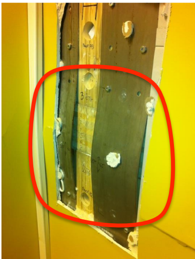
Figur 5.2 Utbuktning på stålförband (inringat i rött), på grund av krympning och deformation av massivträelement i Palisaden.
