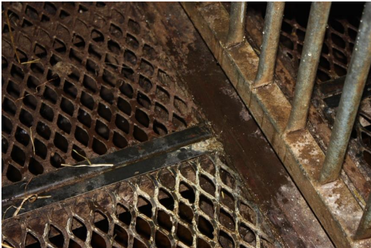
Figur 6 Vannsøl ble i noen binger observert på gulvet under drikkenippel
