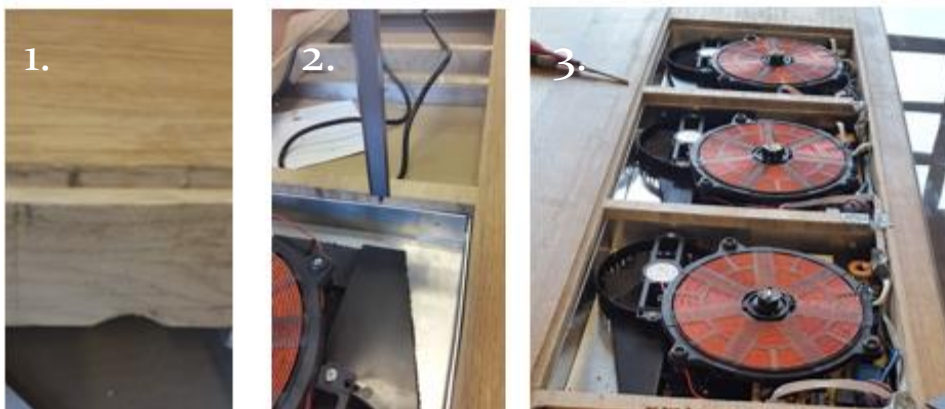
Figur 8.5.6: 1. Utskjæring av hull til hovedstrøm. 2. Måling av modulformenes plassering i utskjært hull. 3. Ferdigmonterte modulformer med induksjonselementer. Egne foto.
