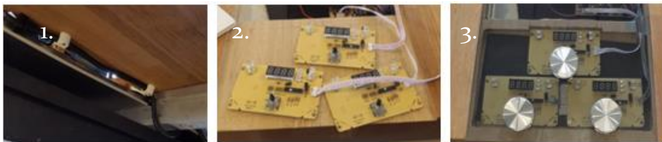
Figur 8.5.7: 1. Festing av hovedstrømkabler. 2. og 3. Montering av styrekort. Egne foto.
