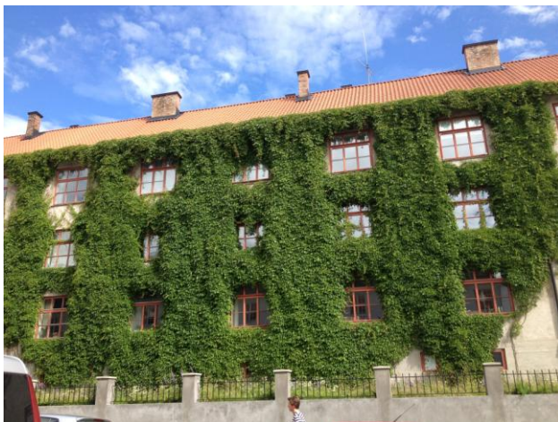
Figur 13: Vegetasjon på murvegg i Oslo. Foto: Sigrid Murud / Bygg og Bevar (Langeland 2014).
