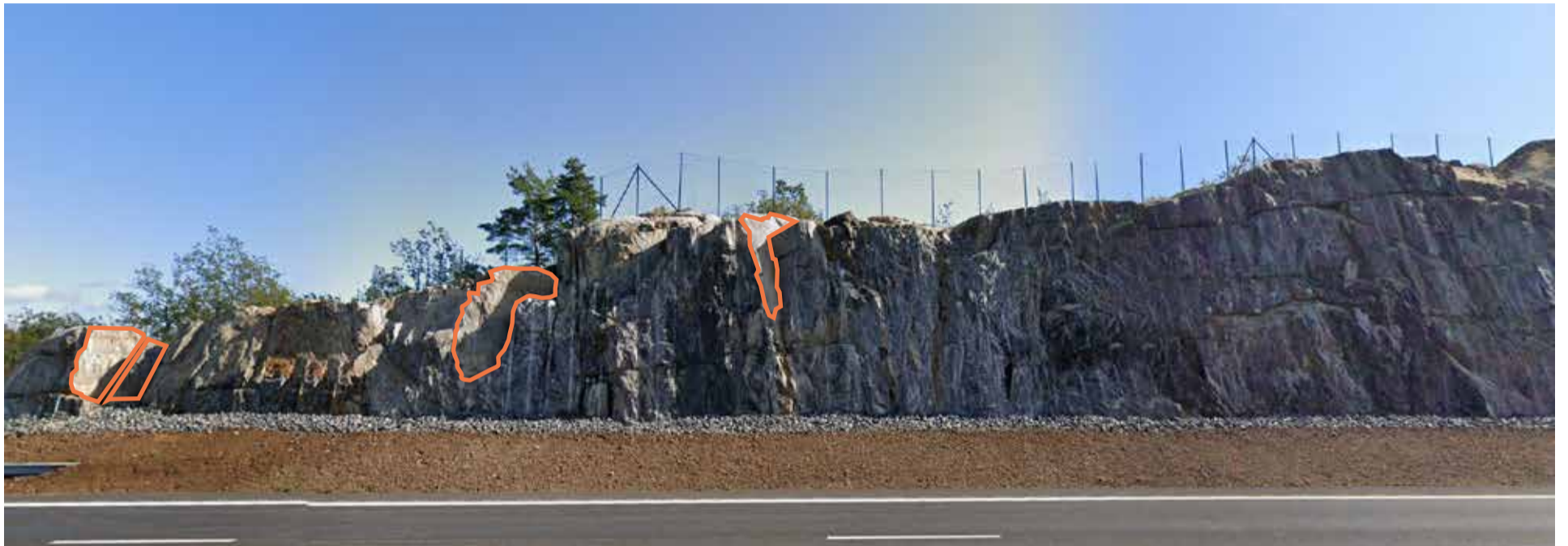
Figur 6-11 Flater i skjæringen. (Bilde hentet fra google.no/maps).
