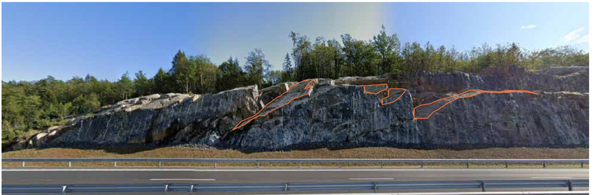
Figur 6-12 Flater i skjæringen. (Bilde hentet fra google.no/maps).
