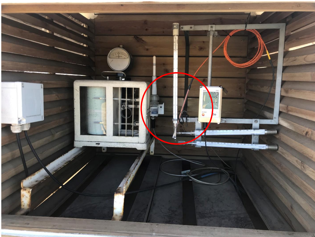
Figur 27: Innsiden av trehytten på Søråsfeltet. PT-100 sensoren er ringet rundt med rødt. Kilde: Mareile Astrid Wolff
