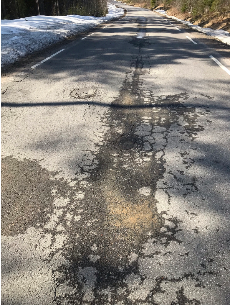
Felt 1 til venstre, felt 2 til høyre. Tydelig oppsprekking og forekomst av vann på midten av vegen, i tillegg til spordannelse.
