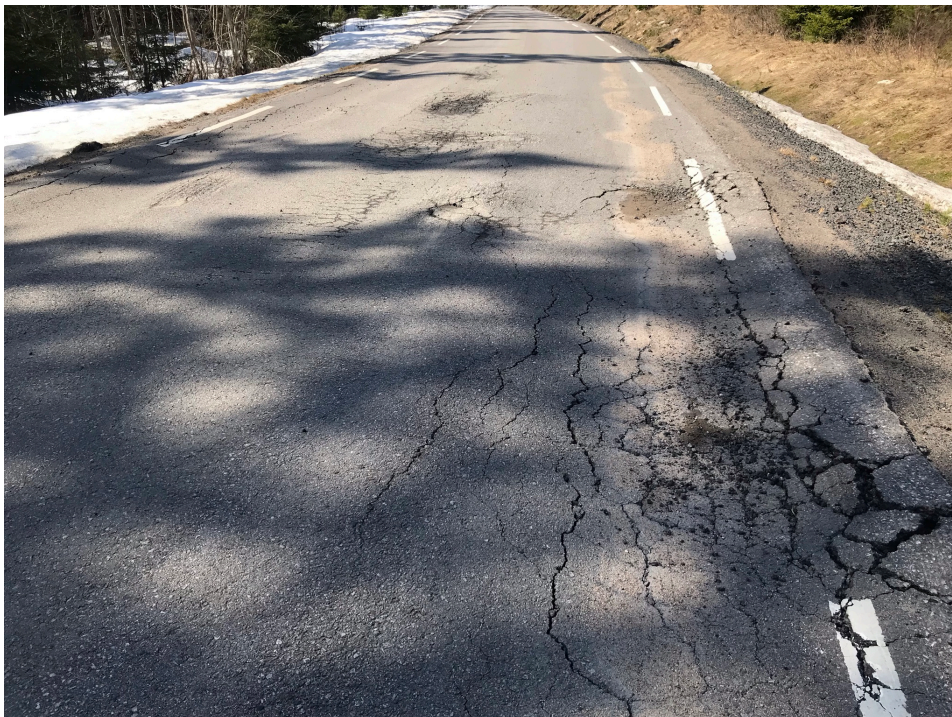
Felt 1 til venstre, felt 2 til høyre. Det er synlig skader i begge felt, spor- og sprekkdannelse.
