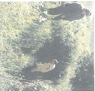
Utløp undergraves, ravin er oppstått
