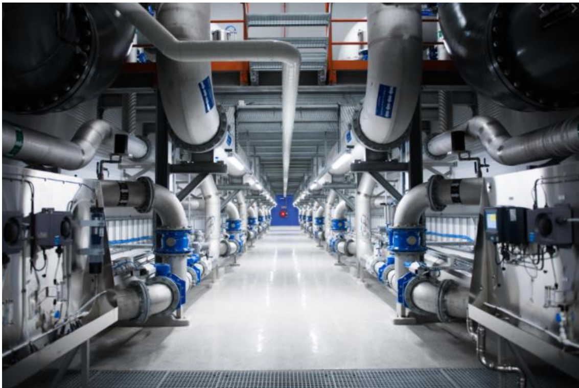
Figur 4: Langevatn vannbehandlingsanlegg (IVAR, 2021).
