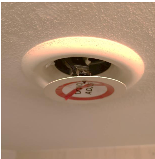
Figur 3-10: Ut-plassering av målesensor (EL-USB-2+) i tilluftskanal (Palisaden) Foto: Cathrine Hafnor
