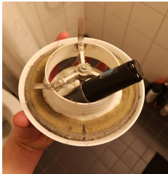
Figur 3-11: Ut-plassering av målesensor (EL-USB-2+) i avtrekkskanal (Palisaden) Foto: Cathrine Hafnor
