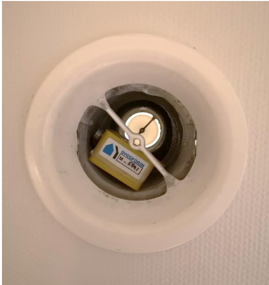
Figur 3-12: Ut plassering av målesensor (TinyTag) i avtrekkskanal på bad. Foto: Cathrine Hafnor
