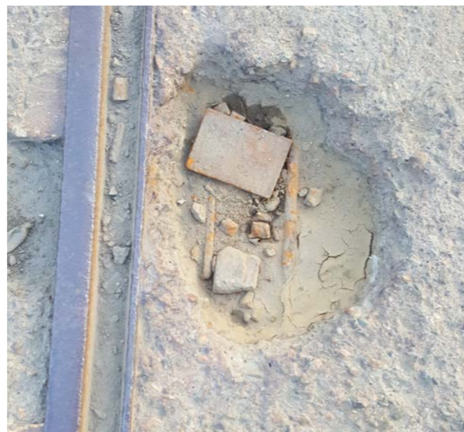
Figur 4.20. Eksempel på skade i det eksisterende betongdekket.
