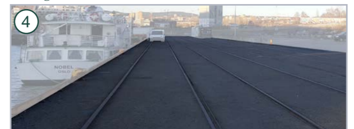
Tilstand: Tilsynelatende god - enkelte partier med mekanisk slitasje.
