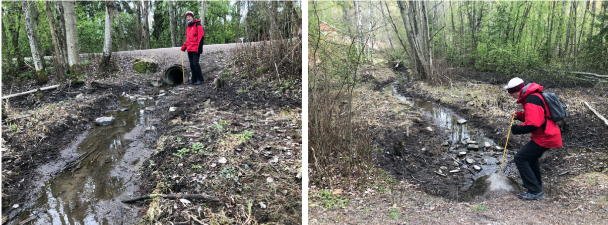
Figur 3.22 Til venstre ser vi røret nedstrøms og til høyre vises oppstrøms anbefalt fordrøyningsanlegg.
