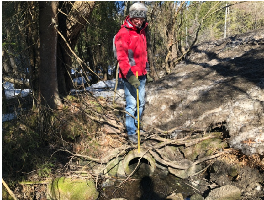
Figur V.10 Her sees røret der normalvannføringen renner gjennom. Til høyre i figuren ligger bilveien.
