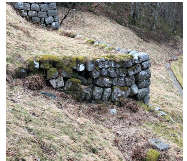
Figur 5.61 Steiner i murene har begynt å falle ut
