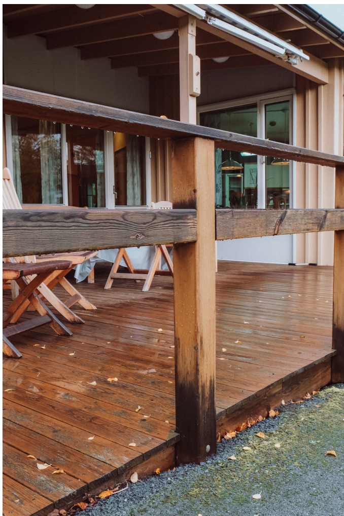
117 Fig 141: Terrassen oppleves som en viktig buffersone både ved Sonjatun og Alta omsorgssenter
