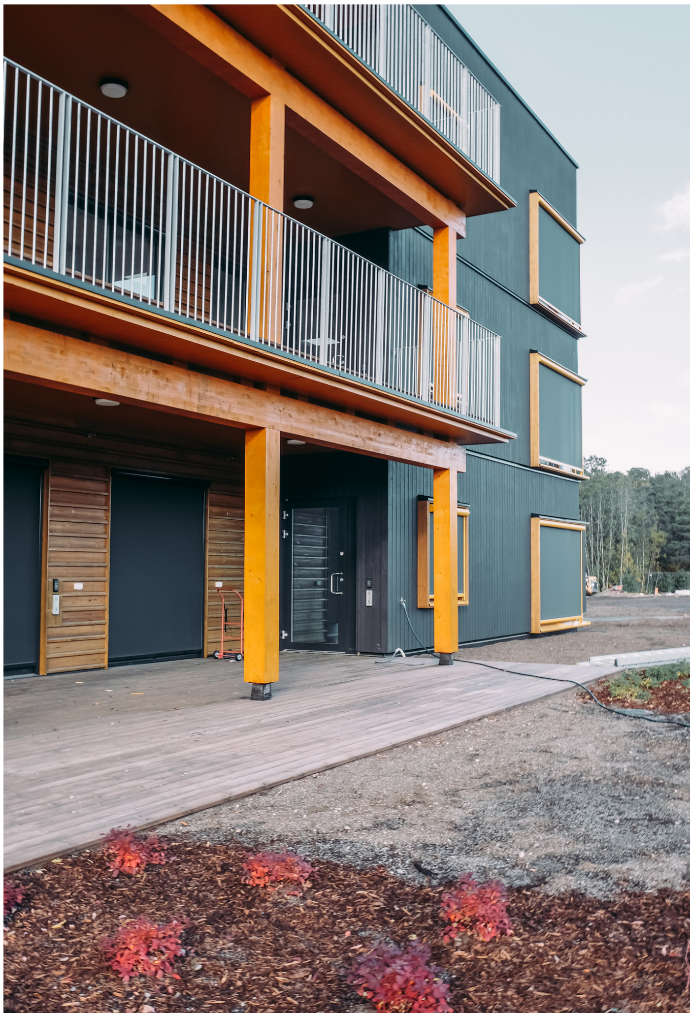
111 Fig 131: Her er tenkt ingen kant mellom terrasse og sansehage ved Alta omsorgssenter. Belegg på gangvegen manglet under befaring 24.09.20
