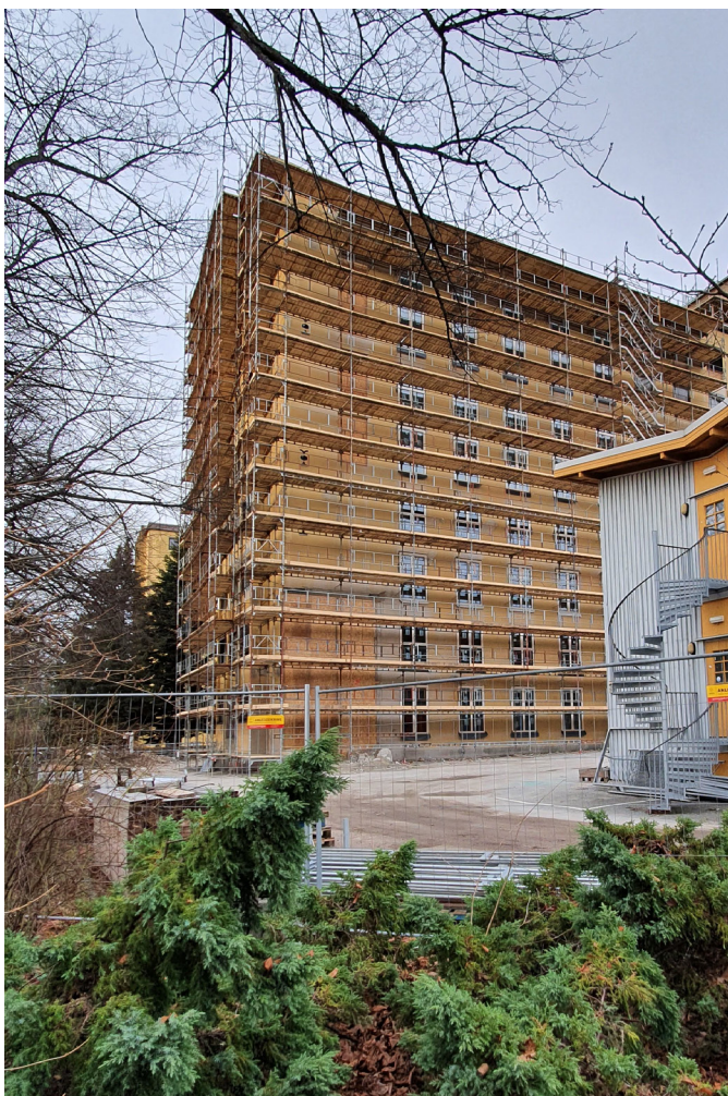
Befaring i januar viser at de er i full gang med byggearbeidet på blokk A. Fasadene forandres og vinduene skiftes.
