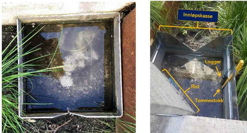
Bilde 2.5: Venstre: Viser innløpskassen i regnbedene. Høyre: Innløpet i R1, med forlengt V-overløp, og verktøy som er utnyttet i testingen. Logger og tommestokk målte vannstand, og rista reduserte vannhastigheten.
