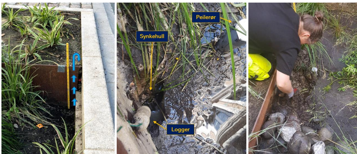
Bilde 3.1: Første bildet (venstre) viser hvor vannet gikk i overløp under 20 års oversvømmelsen i R7, fra regnbedkanten til blomsterbedet. Neste bildet viser synkehullet som oppstod under 20 års oversvømmelsestesten i R7, ved logger «UT2» og peilerør. Luftrommet var større under jordoverflaten, som vist i det siste (høyre) bildet.
