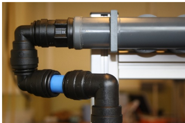
(b) Rør inn til manifold.
