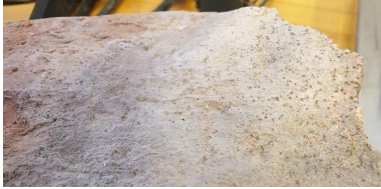
Figur 3.6: Foto av prøve S1, viser puss på overflaten.
