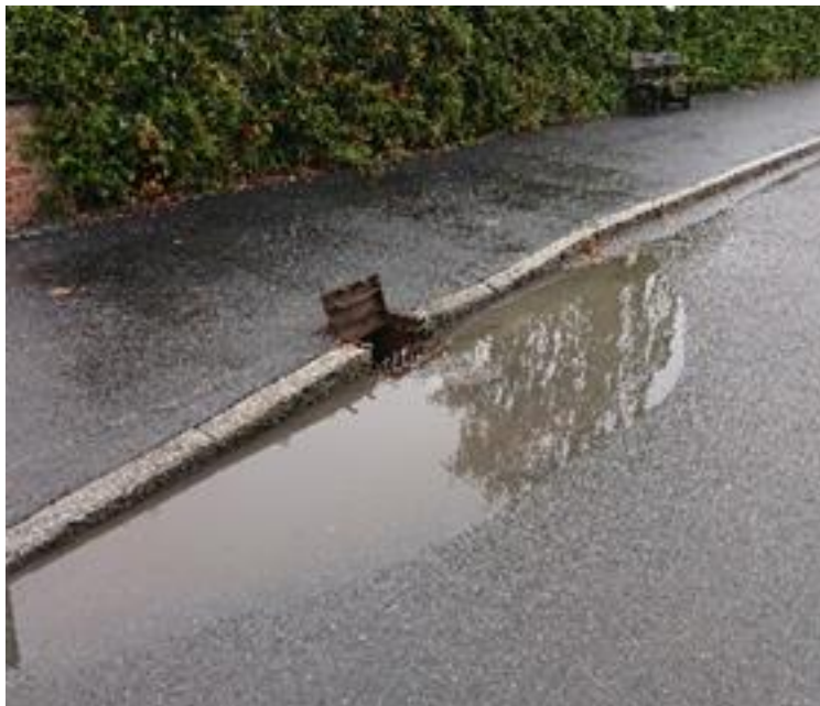
Figur 33 Bildet av sluken til sandfanget på Otto Blehrs vei
