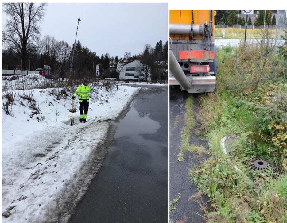
Figur 44 Vogellund bisluk m/ grøft og smeltevann på vei. 04.03.2020 Figur 45 Tømming 30.08.2017 Asker Drift
