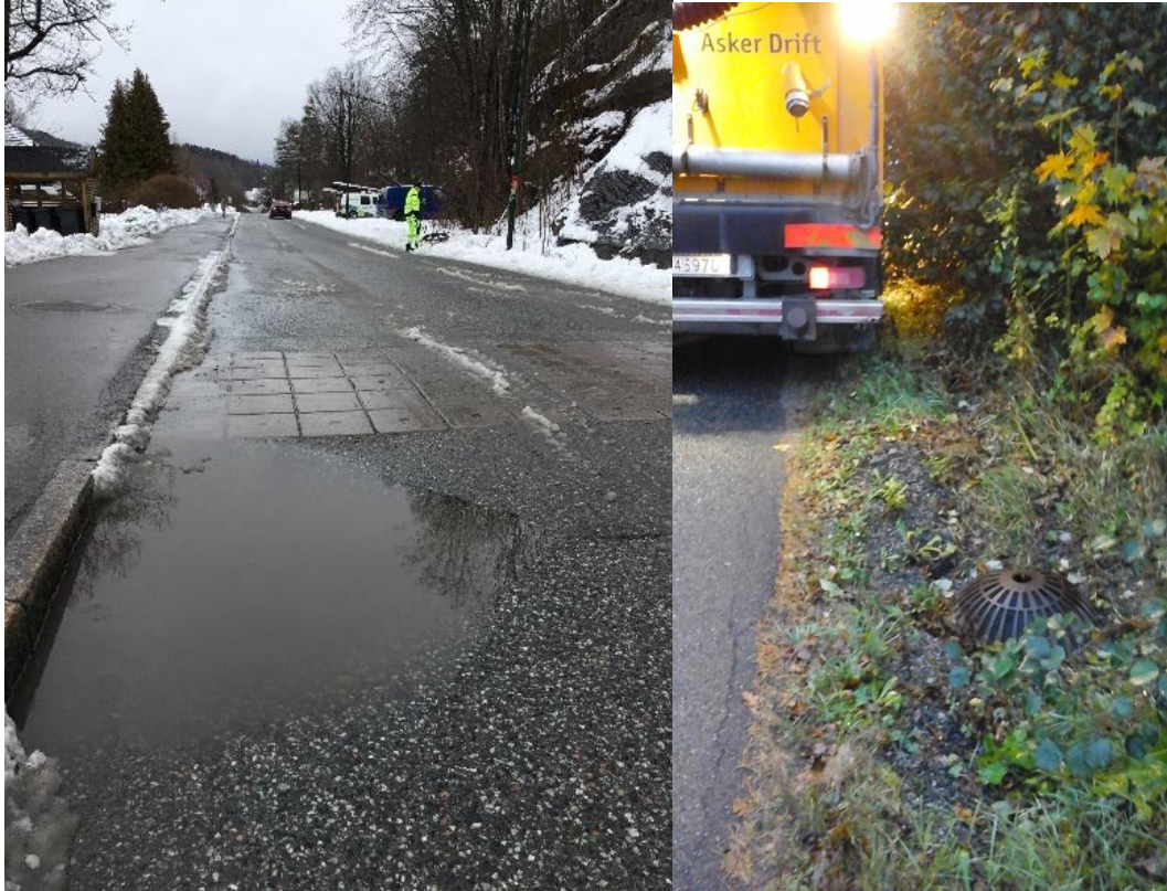
Figur 37 Nedbørsfelt over bisluk v/ Undelstadveien fra midt av nedbørsfelt 04.03.2020 og tømming ved Asker Drift 11.10.2017.
