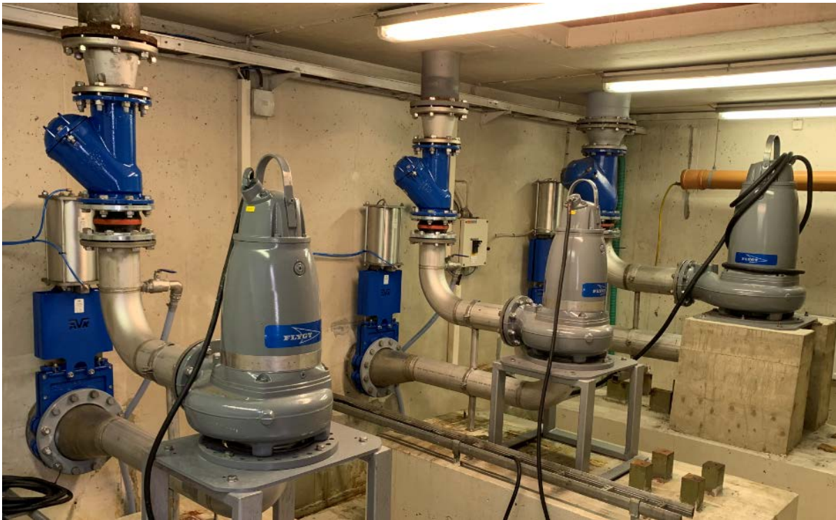
Figur 3.20 Pumpene ved KP Havstad
