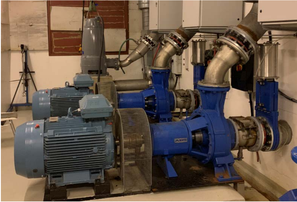
Figur 3.25 Pumpene ved KP Kolbjørnsvik
