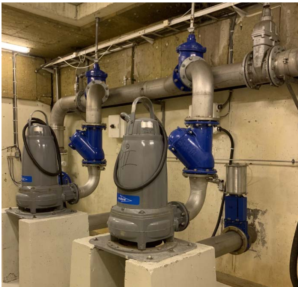
Figur 3.14 Pumpene ved KP Skibevik
