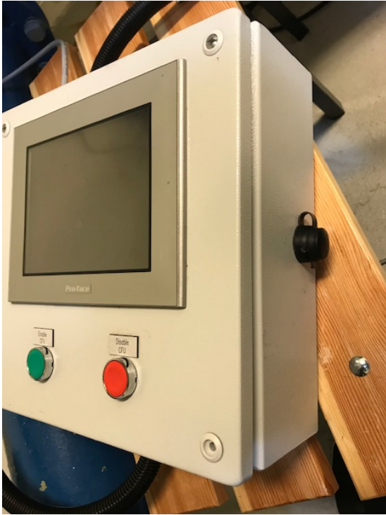
Figur 25: Styringsenheten til pilotanlegget med touch screen. Foto: Undertegnede.
