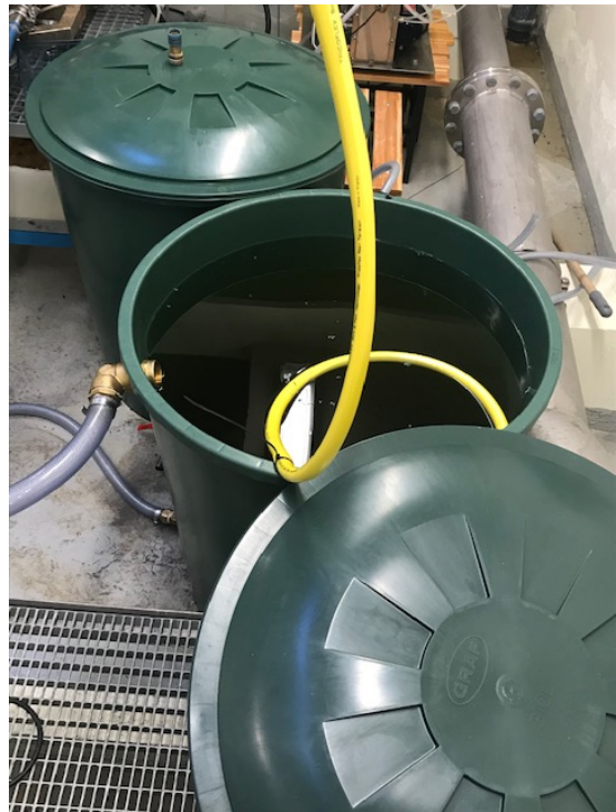
Figur 22: Råvannstanken etter forfilter. Foto: Undertegnede
