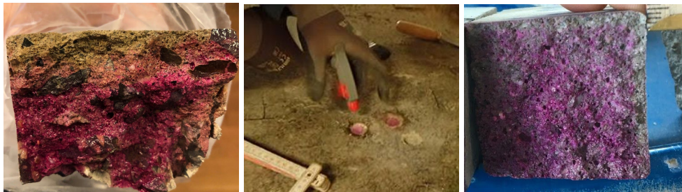
Figur 3.9: Karbonatisering i a) betong b) borehull c) mørtel
