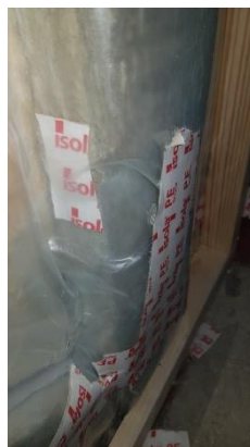
Figur 44 - Lekkasje ved teiping på grunn av krøllete diffusjonssperre, leilighet 401 Foto: Petter Fossum
