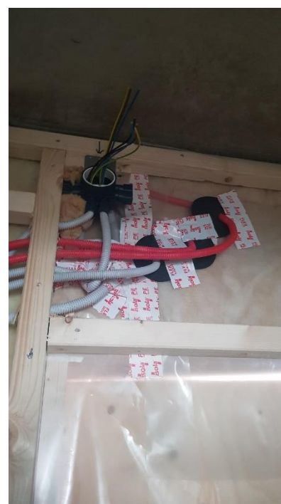
Mansjetter over inngangsdør
