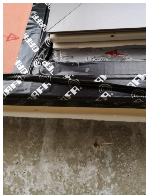
Åpning mellom fug og teip
