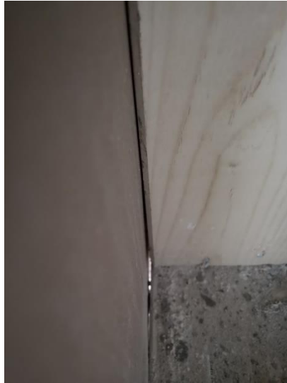
Figur 42 - Glippe mellom vindsperre og stender, leilighet 401 Foto: Petter Fossum
