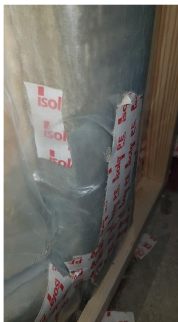
Lækker gjennom teiping pga. brett på diffusjonssperre
