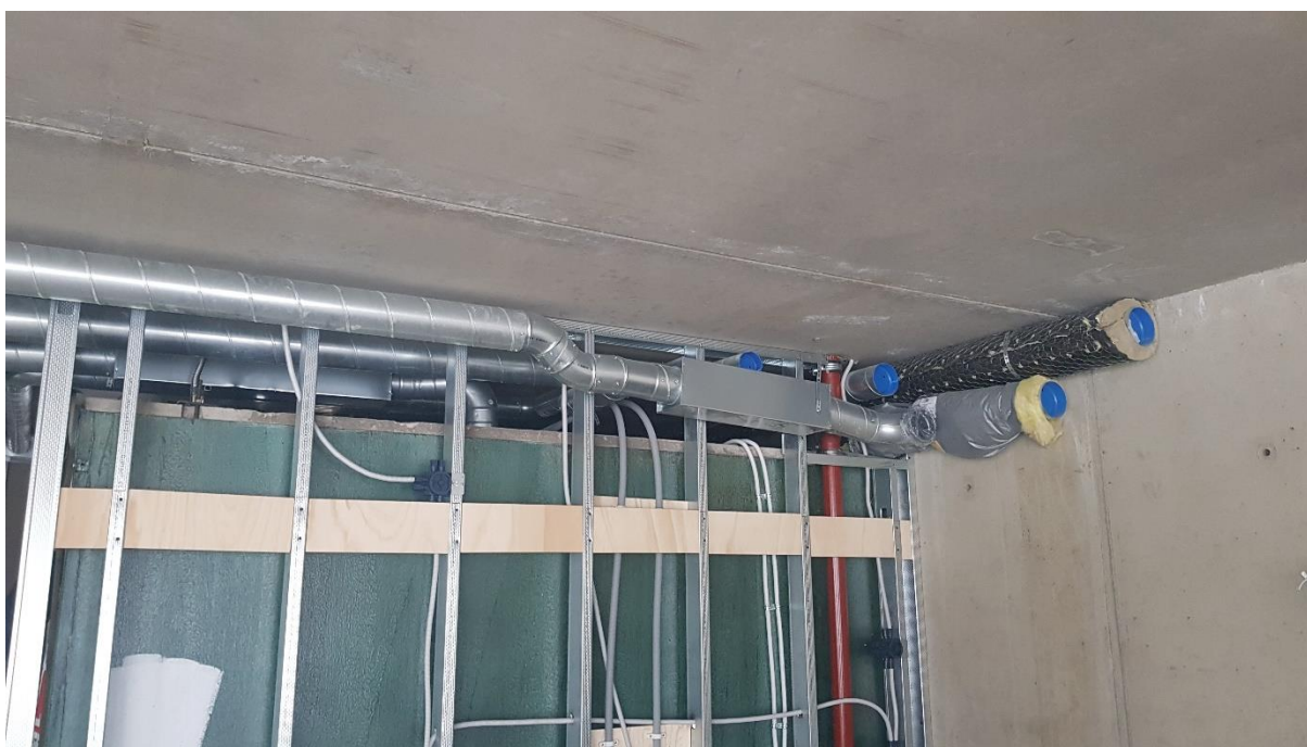
Ventilasjon tettet med teip
