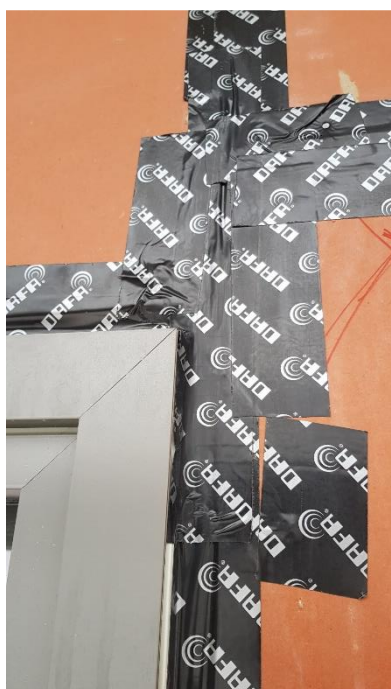
Forsøk på utbedring av teiping med dårlig heft
