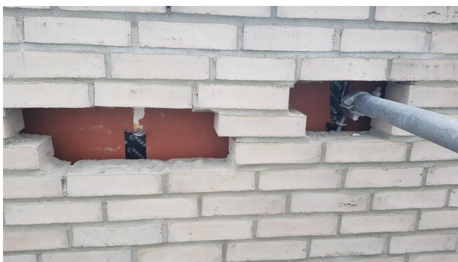
Svak teiping mot stillasforankring
