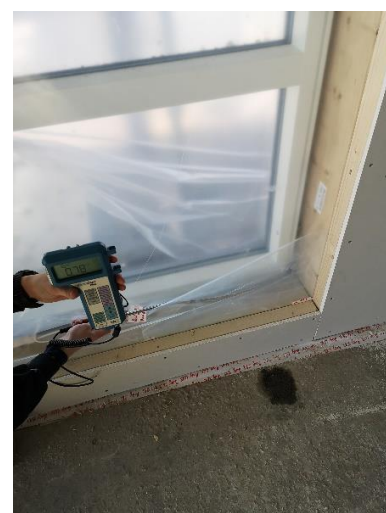
Lekkasje rundt stort vindu i stue (0.43 m/s)
