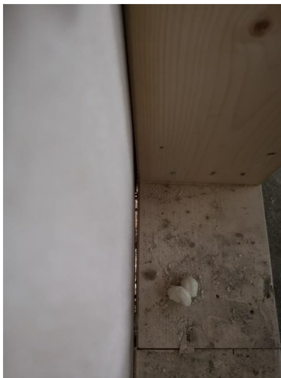
Dårlig klem av gips mot bunnsvill (lyset slipper gjennom)
