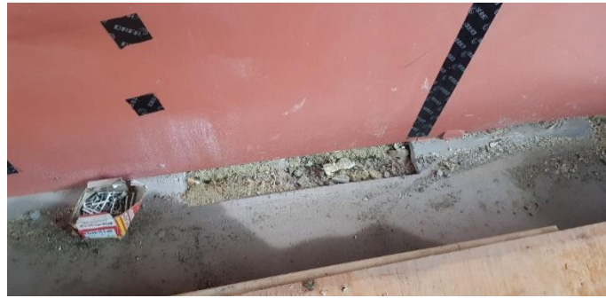
Figur 39 - Manglende fug mot dekke, leilighet 301 Foto: Petter Fossum
