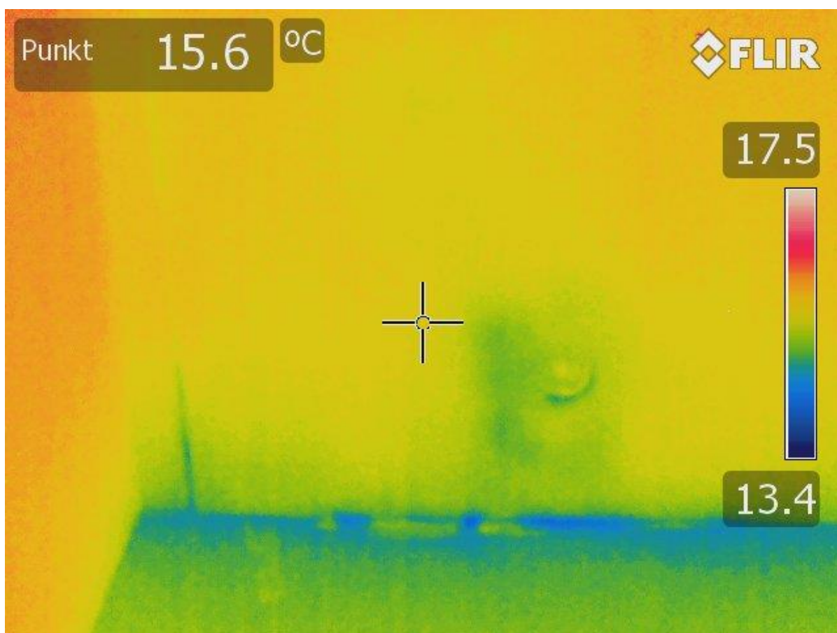
Lekkasje fra gipsskjøt (0.3 m/s) og lekkasje rundt stikkontakt plassert i yttervegg.
