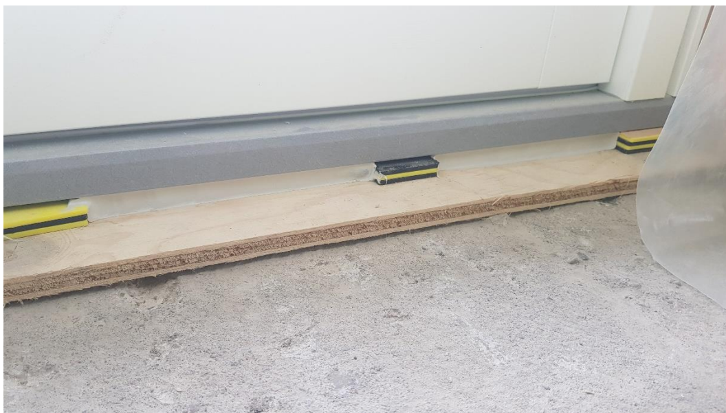
Lekker gjennom nivåklusser under balkongdør. Fug burde ligget utenpå klossene
