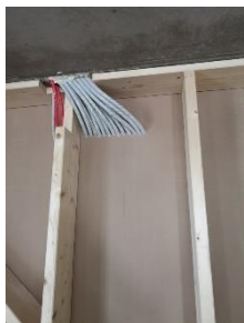
Figur 46 - Samling av K-rør Foto: Edvard Hogstad
