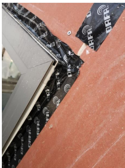
Figur 37 - Manglende teip av vindsperreskjøt, leilighet 201 Foto: Edvard Hogstad
