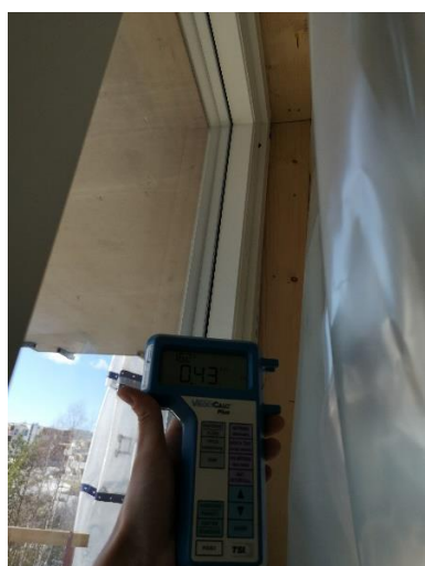
Lekkasje rundt stort vindu i stue (0.78 m/s)
