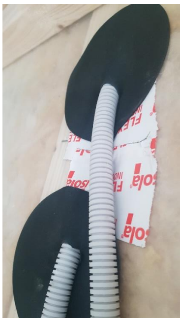
Løs mansjett ved balkongdør (ovenfor nederste k-rør)
