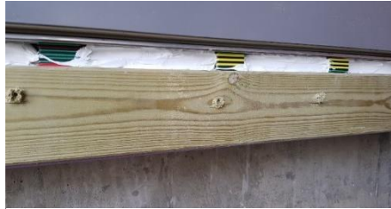
Figur 56 - Manglende fug under dørterskel
