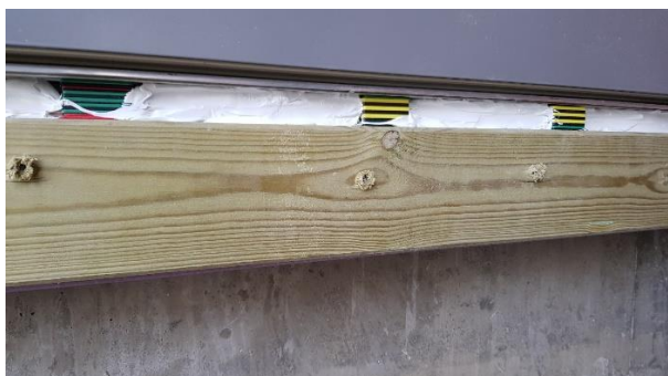
Fug burde overdekket klosser
