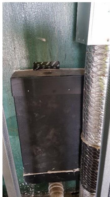
Teipet lekkasje på badromskabin
