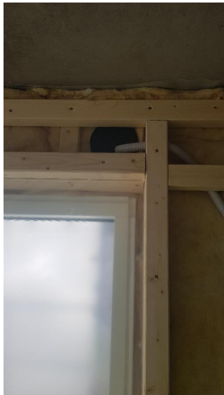
Vanskelig å få på mansjett når gjennomføring er så tett på lekter
