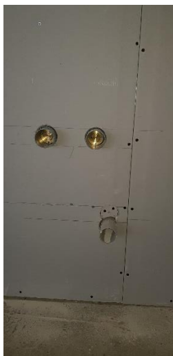
Tilførsel og avløp til kjøkken, teipet før måling
