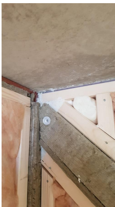
Lekkasje ved dekke/søyle/skråsøyle
