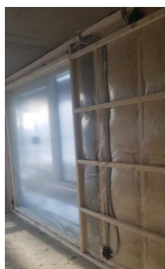
Iskaldt ved mansjett over vindu. Nederste bilde er fra før montering av gips
