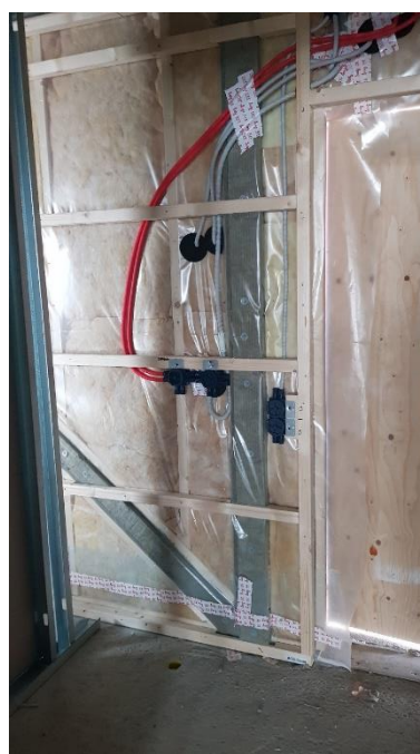
Kaos av gjennomføringer og mansjetter ved inngangsdør
