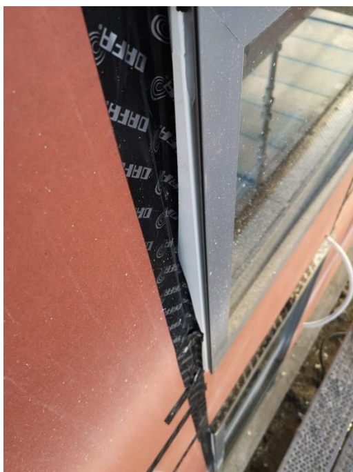
Unøyaktig teiping, ser rett inn til isolasjon
