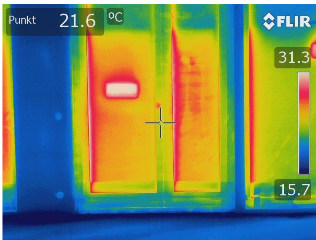
Lekkasjer under balkongdør, v. 50pa undertrykk (0.44 og 1.13m/s)
