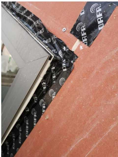
Eksempel på dårlig teiping av skjøt og vindu
