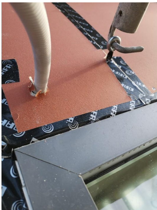
Mansjett til k-rør ligger på innsiden
