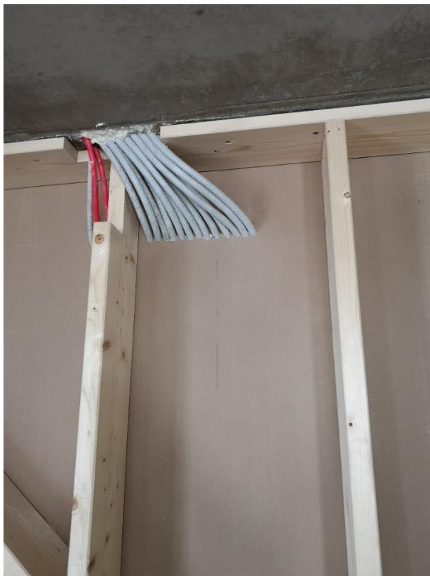
Samling av k-rør til sikringsskap, ingen tetting utført.
