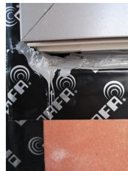
Figur 51 - Fug under vindu Foto: Petter Fossum
