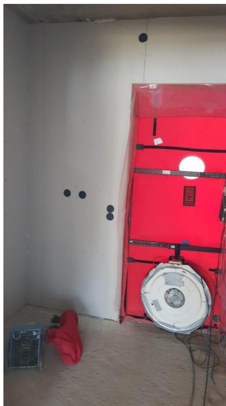
Lekkasjer fra stikk og gipsskjøter over inngangsdør
