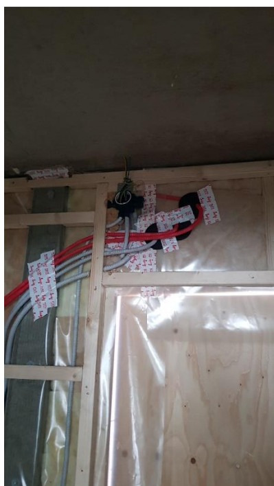
Mansjetter over inngangsdør
