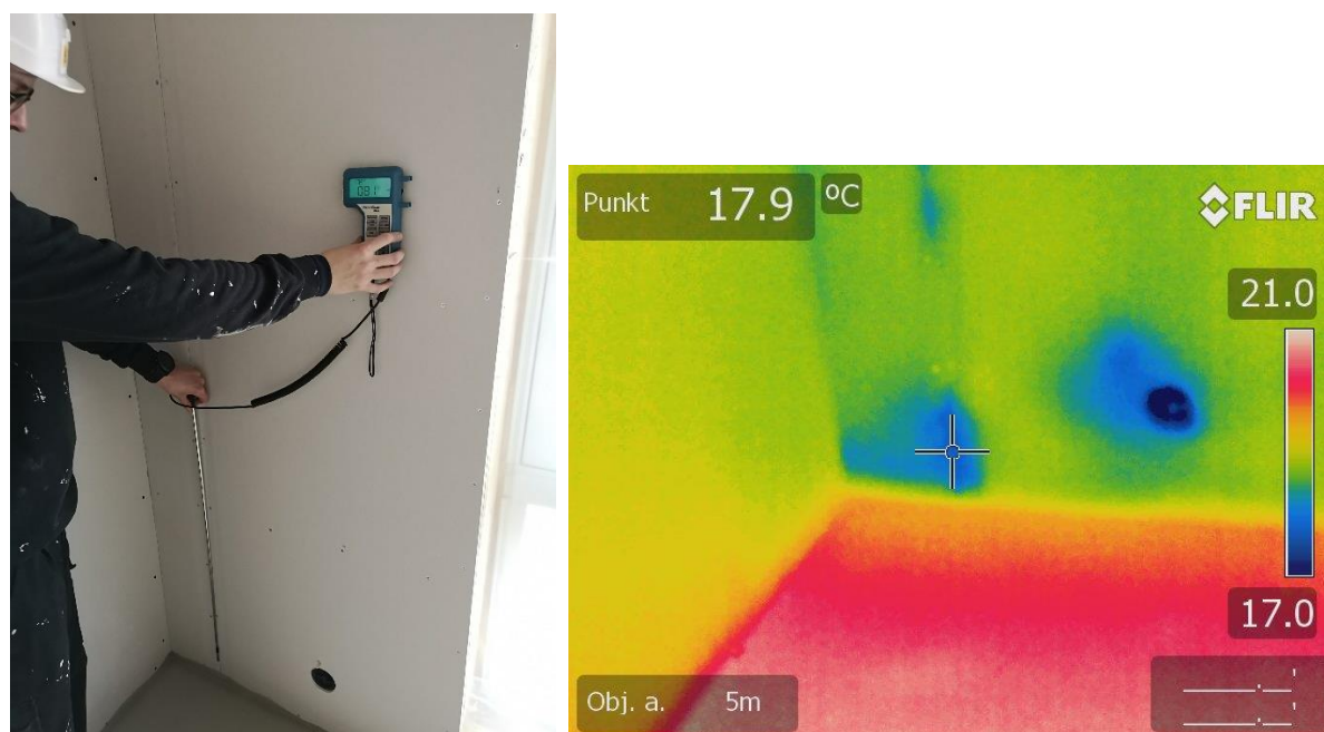
Lekkasje ut av gipsskjøt (0.81 m/s)
