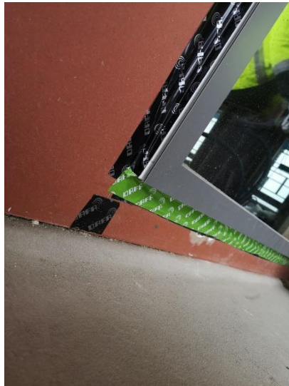
Figur 43 - Provisorisk tetting (grønn teip) og manglende fug mot dekke, leilighet 401 Foto: Petter Fossum
