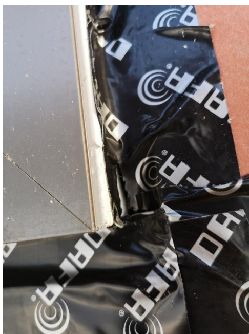
Skåret feil i teipen, ser rett inn til isolasjon
