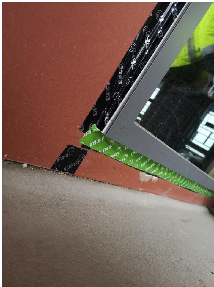
Provisorisk teiping av vinduer, grunnet mangel på fug i underkant
