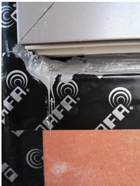
Utett fug i underkant vindu
