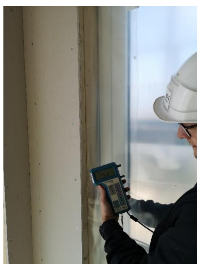
Lekkasje rundt stort vindu i stue (0.51 m/s)
