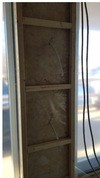
Figur 40 - Manglende mansjett på diffusjonssperre, leilighet 301 Foto: Petter Fossum
