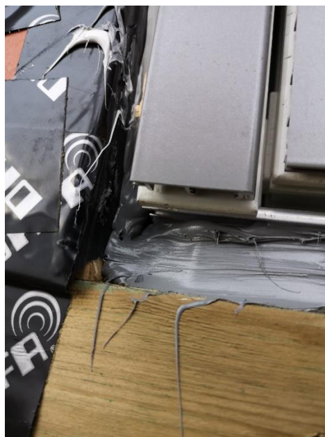
Åpninger i fug under dør
