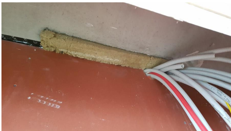
Føringsvei for EL, trangt å tette mtp. lufttetting
