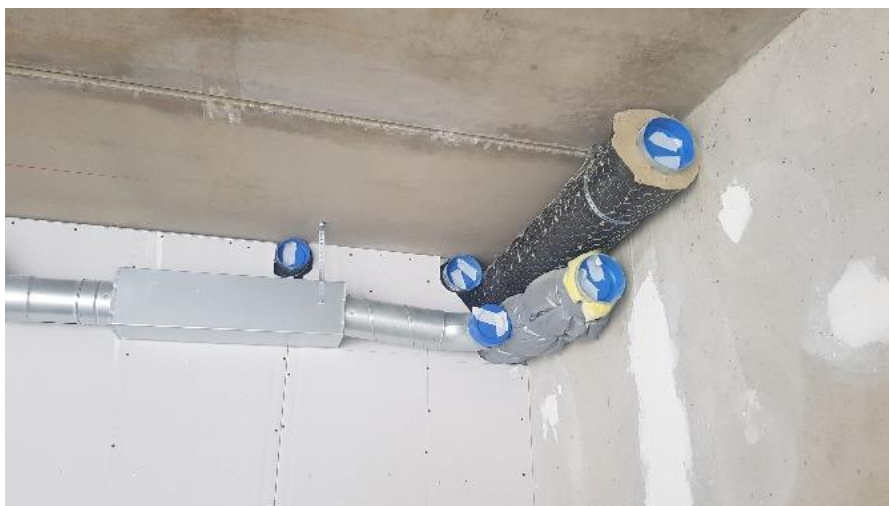
Ventilasjon teipet provisorisk
