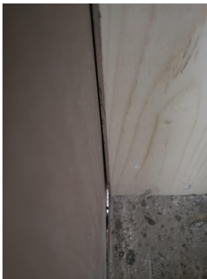
Dårlig klem av gips mot bunnsvill.
