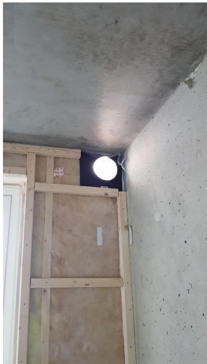
Mansjett rundt gjennomføring av tilluft
