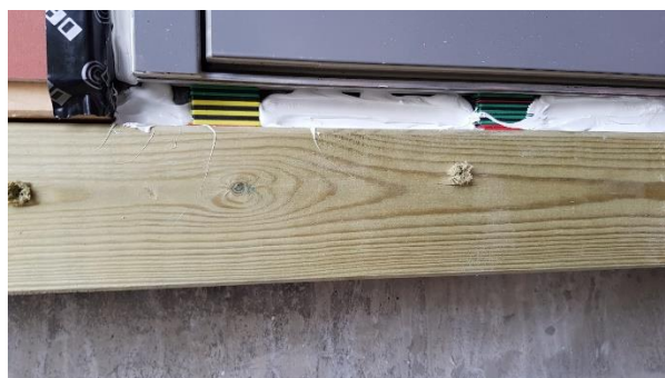
Tydelig bruk av for lite fugemasse
