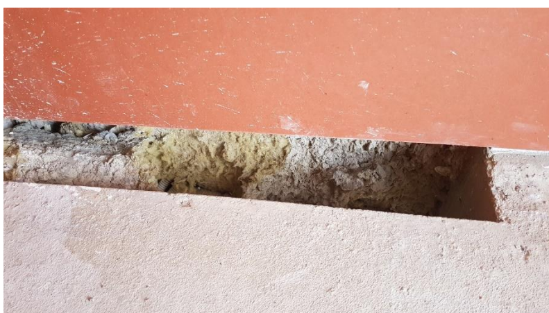
Føringsvei for EL gjør det vanskelig å tette godt
