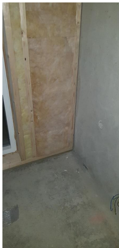
Lekkasje fra hjørne naboileilighet/svalgang
