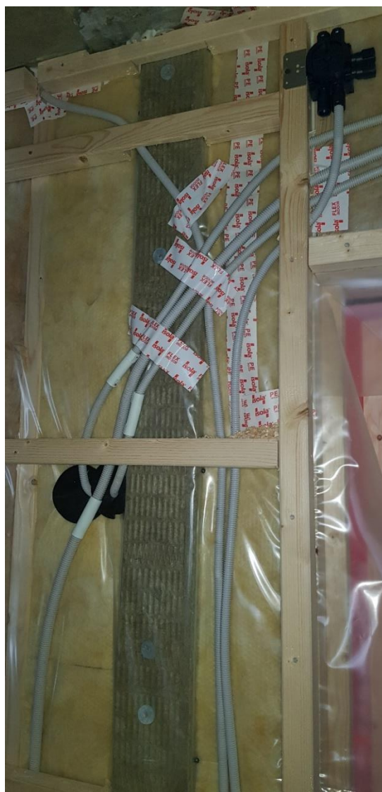
K-rør ved mansjett blir strukket ved mansjett. Fører til liten klem rundt selve k-røret.
