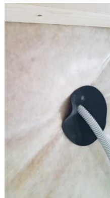
Figur 53 - Svak utførelse av mansjett Foto: Edvard Hogstad
