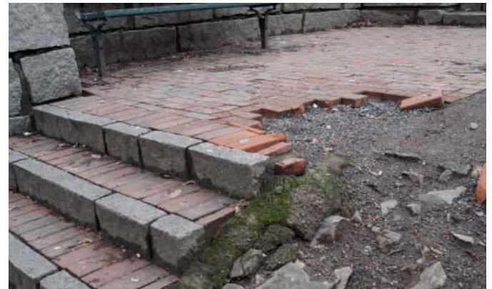
Manglende reparasjoner på trapper
