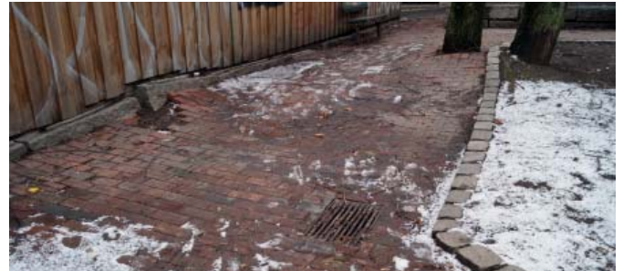
Dekket bærer preg av oppsprekking og slitasje
