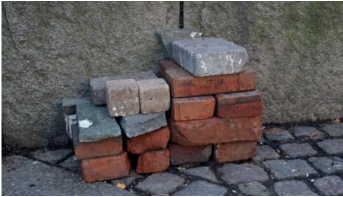
Teglsteinsdekket har sprukket opp flere steder
