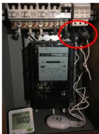
Figur 3-9 Energimåleren montert i sikringsskapet.
