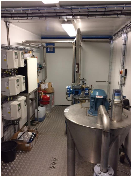
Figur 5 Teknikk-konteiner med dissolver i forgrunnen. Rundpumping for oppvarming i bakgrunnen. Foto: Joshua Cabell
