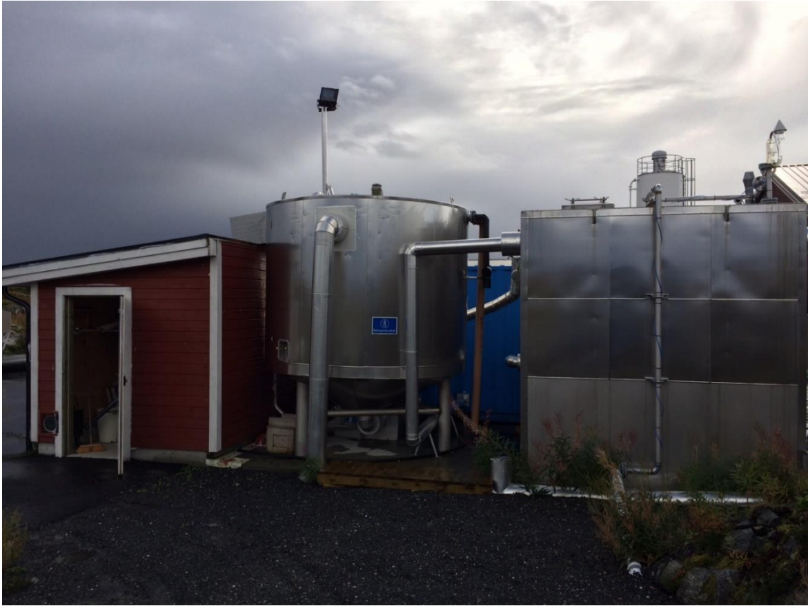
Figur 4 Reaktoren med 4 kammer isolert og innbygd til høyre. Hydrolysetank midt i bildet. Teknikk-konteiner skimtes bak hydrolysetanken. Foto: Joshua Cabell
