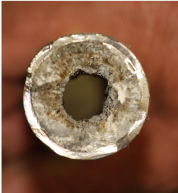
Figur 8. Stuvittutfelling i rørledning. (Foto: Odd Jarle Skjelhaugen).
