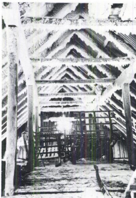
Fig. 15. Klimaet i husdyrrommet har betydning både for dyrene, røkteren og bygningen. I fjøset i denne bygningen er det ikke kontrollert ventilasjon. Fuktig luft har trengt opp gjennom utettheter i himlingen, og det er blitt kondens og rim på låvekonstruksjonene. Husdyrrom må være tette og utstyrt med undertryksanlegg som hindrer fuktig luft i å trenge seg inn i konstruksjonene eller ut til tilstøtende rom.
