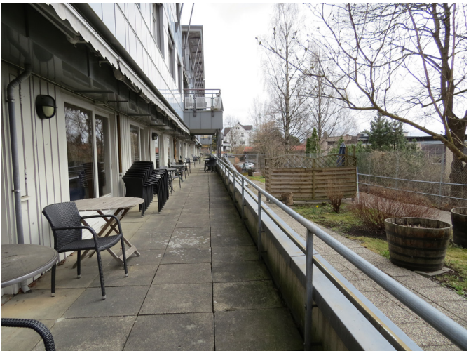
A. (Tatt mot øst, fra sørsiden av bygget). Bildet viser smalgangen som ligger mellom post 2 og hagen, og de løse betonghellerne her.
