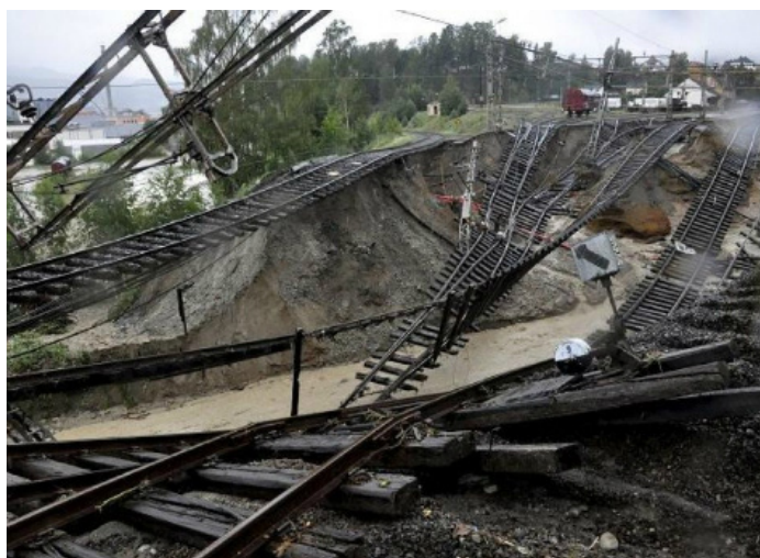
Figur 2.21. Skader av flommen 24/7-2011 på jernbanen på Notodden, Telemark.
