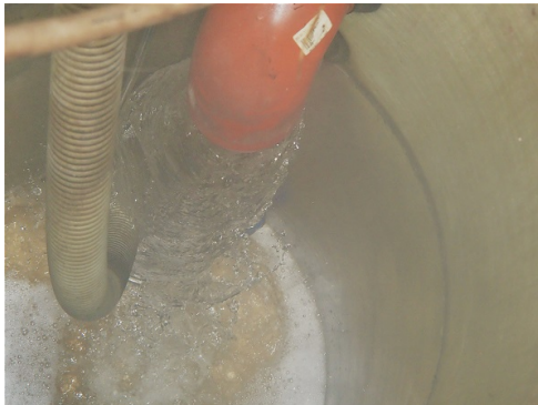
Figur 6.4: Vannstrøm ut av biofilteret etter manuell oppstart av pumpe i Wallax-anlegg.
