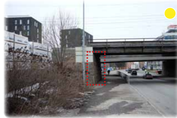
Bilde. 1.3.4. I et trangere parti under jernbanesporene (rød firkant) kan bekken legges i rør. En annen løsning er at steinfundamentet til jernbanen flyttes litt sørover.
