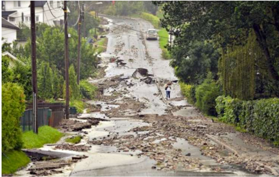
Figur 2-10: Skade på vei som følge av erosjon
