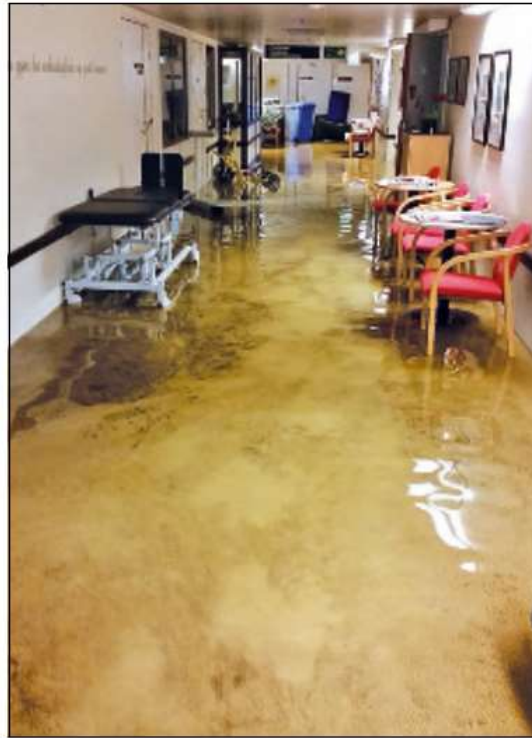
Figur 2-9: Sykehuset på Sørlandet under flommen november 2014 (Skaaraas, Overvann i byer og tettsteder, som problem og ressurs, 2015).
