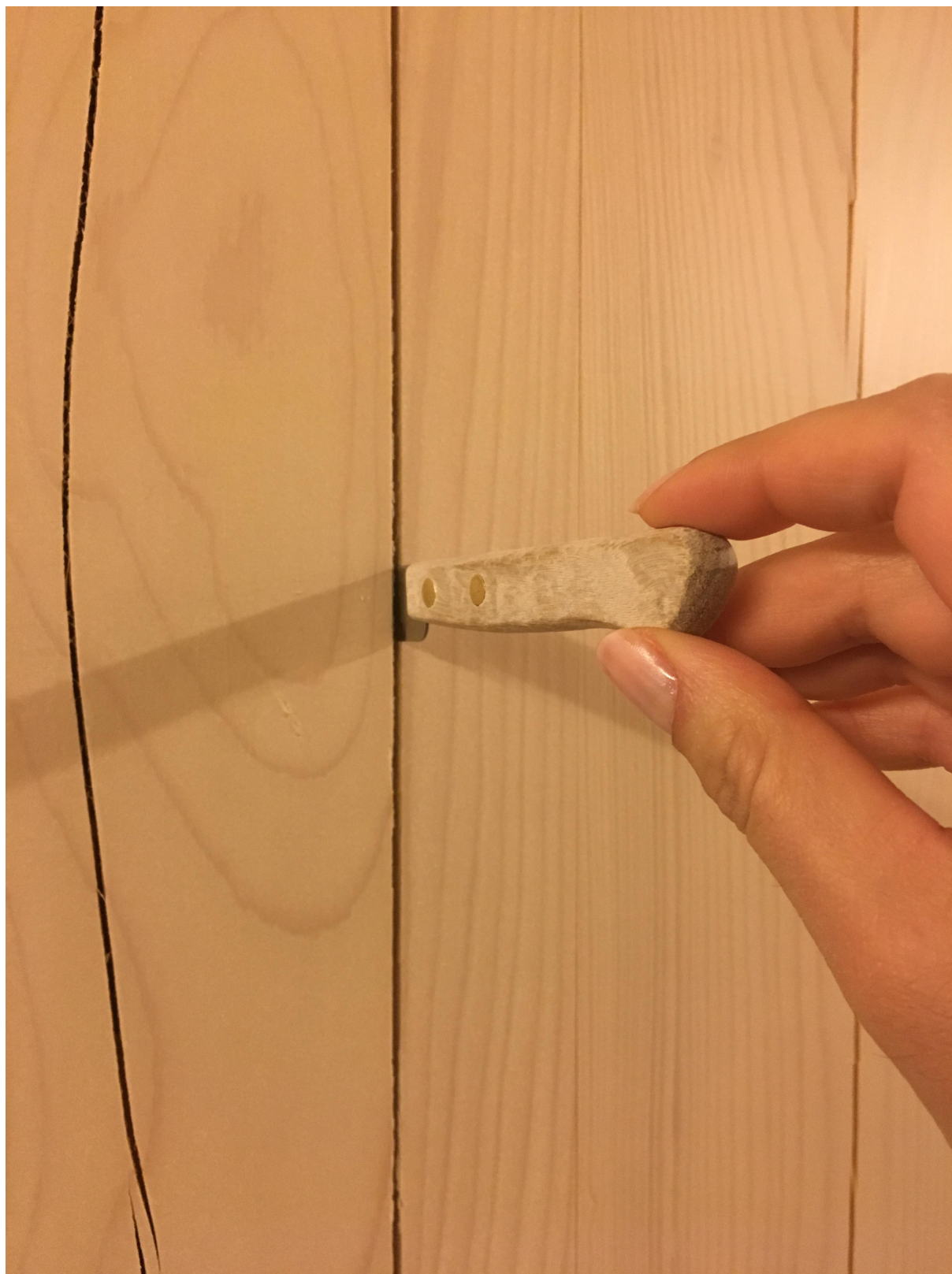
Figure 1 Figuren viser at sprekken mellom to massivtreelementer kan bli stor nok til at et knivblad på omtrent 15 cm kan trenge hele veien inn
