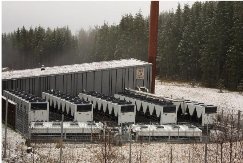
Figur 14: Bak fra høyre: KM2, KM3-6, foran: 2 tørrkjølere
