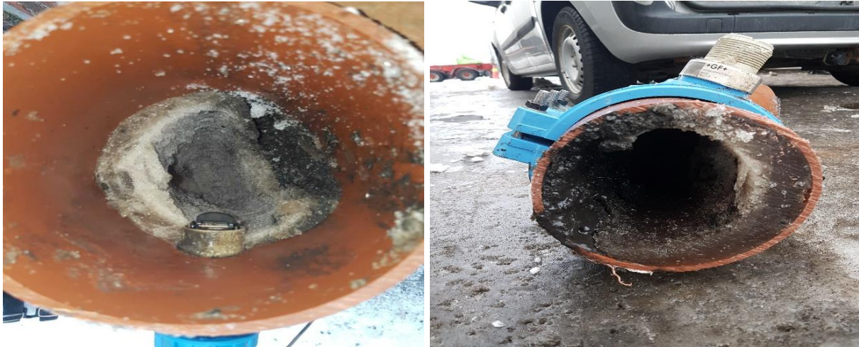
Figur 4.2: Innvendig rør ved demontering. Bildet til venstre viser hvordan det så ut inne i røret når det ble undersøkt på verkstedet. Bildet til høyre viser innvendig rør ved demontering på området (ITAS, 2018c).
