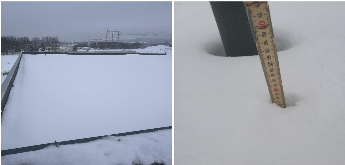
Figur 4.15: Bilder av snøen på taket den 22. januar 2018. Bildet til venstre viser snøen fordelt på taket. Bildet til høyre viser måling av snøen med tommestokk.
