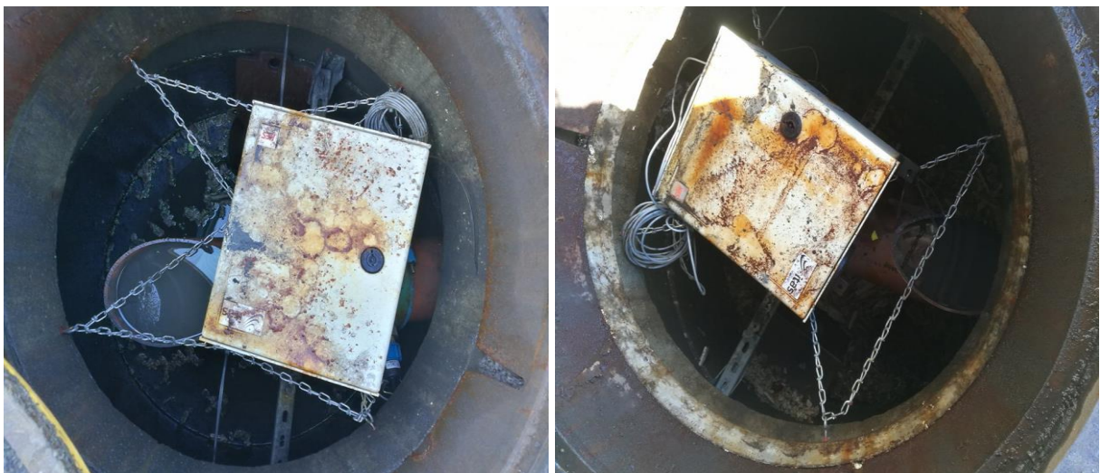
Figur 4.4: Sandfangskummene den 6. april. Bildet til venstre viser kum nord og bildet til venstre viser kum syd. Begge rørene er helfylte.
