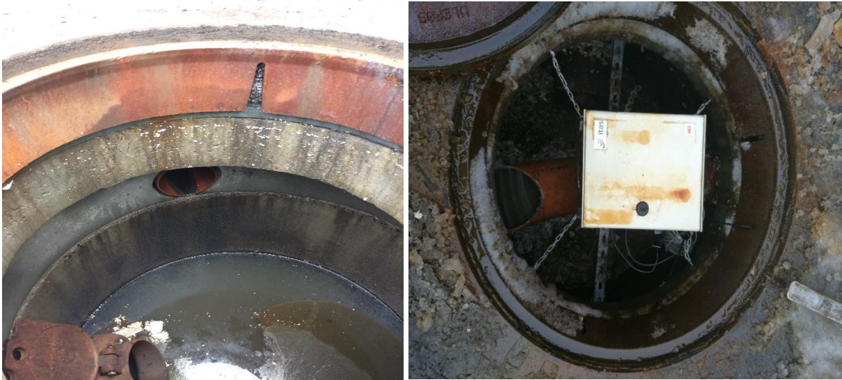
Figur 3.12: Montering og skjøting av langbendet og flow-sensoren den 13. desember 2017 med ITAS. Bildet til venstre viser sandfanget før montering og innløpsrøret fra slisserennene. Bildet til høyre viser ferdig montert løsning med skjøtet langbend fylt med vann, flow-sensoren montert og sikringsskapet.
