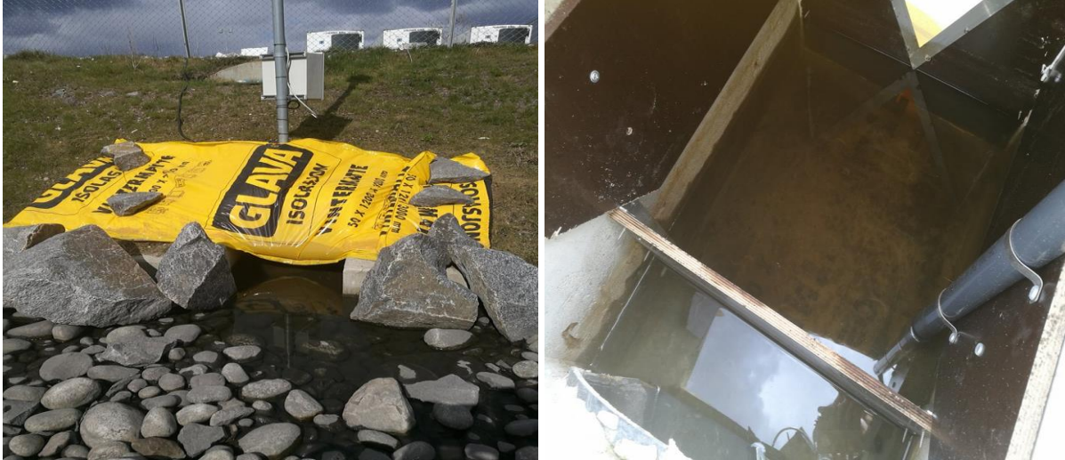
Figur 4.11: Bilder fra befaring den 25. april 2018. Bildet til venstre viser nedbørmåleren og løsningen med V-overløp for det grønne taket. Bildet til høyre viser magasinet på innsiden av løsningen.
