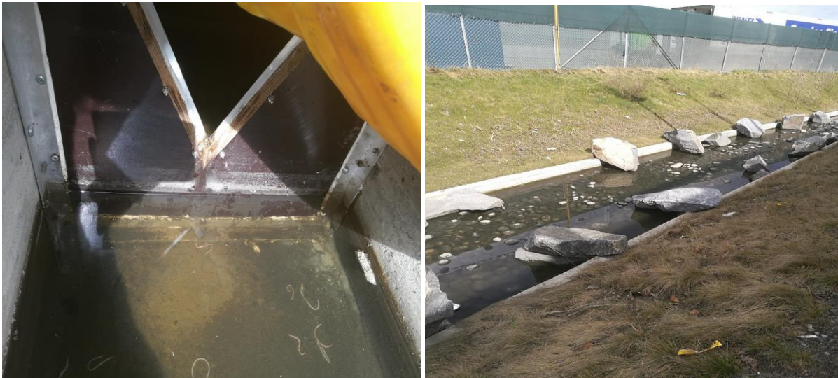
Figur 4.12: Rensedammen og utsiden av V-overløpet den 25. april 2018. Bildet til venstre viser hvor mye vann som befant seg på utsiden av V-overløpet etter våravrenning fra området. Bildet til høyre viser deler av rensedammen der løsningen til det grønne taket befinner seg. Rensedammen er delvis fylt opp med vann.
