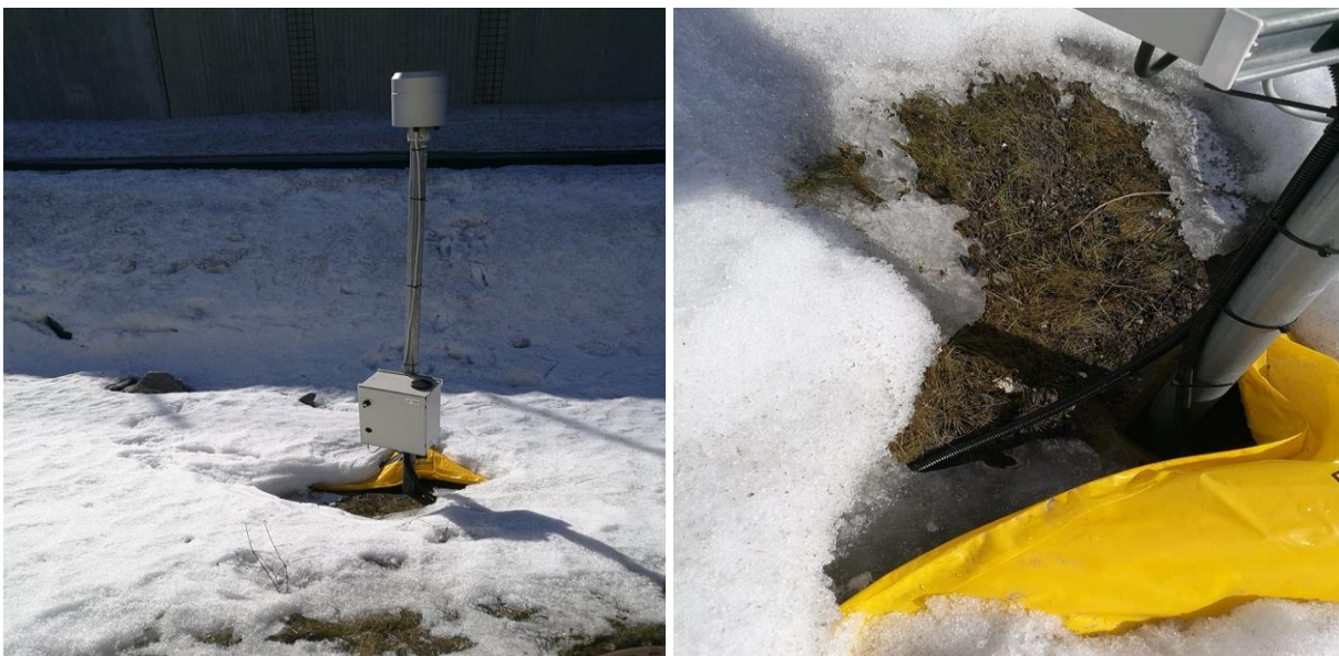
Figur 4.10: Løsningen for utløpet til det grønne taket den 6. april. Bildet til venstre viser mindre snø enn tidligere over isolasjonsmatten og rundt nedbørmåleren. Bildet til høyre viser en liten åpning i isolasjonsmatten rundt stolpen til nedbørmåleren. Deler av terrenget over har smeltet og kan muligens ha rent ned i magasinet.
