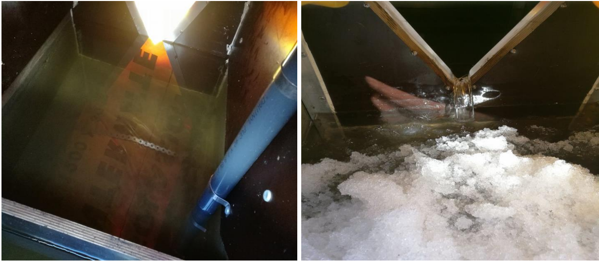
Figur 4.9: V-overløpet den 6. april. Bildet til venstre viser magasinet med en isfri overflate og V-overløpet fra baksiden. Bildet til høyre viser strømmende vann gjennom V-overløpet fra framsiden.
