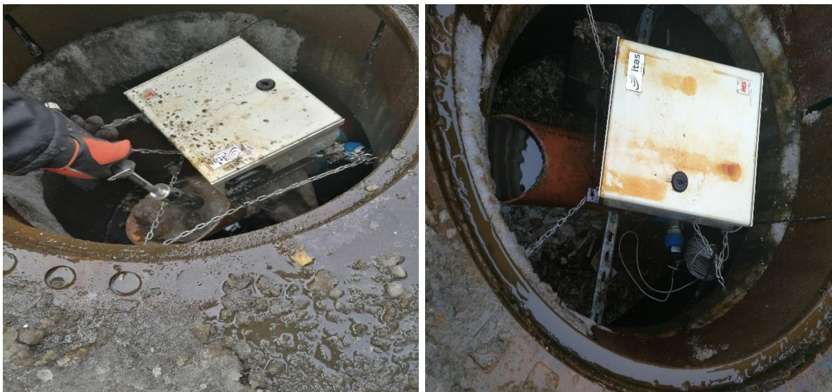
Figur 4.1: Befaring av kummene den 26. januar 2018. Bildet til venstre viser kum nord der røret er helt fylt med is. Bildet til høyre viser kum syd der røret er helfylt med vann. Det var ingen registrerte målinger.
