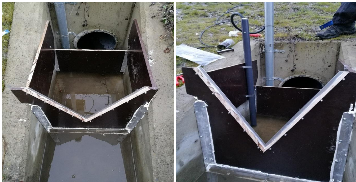
Figur 3.10: Montering av V-overløpet og ultralydsensoren den 27. november 2017 med ITAS. Bildet til venstre viser løsningen ovenfra, uten montering av ultralydsensoren. Bildet til høyre viser V-overløpet ferdig montert med ultralydsensoren som befinner seg i det gråe røret. Den loddrette platen er plassert et stykke foran utløpet for å sikre laminær strømning inn mot sensoren.
