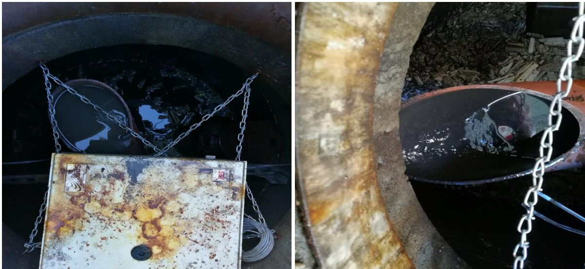
Figur 4.5: Vannkvaliteten i rørene den 6. april. Bildet til høyre viser mengden grums og partikler i røret til kum syd. Bildet til venstre viser isklumper på vannoverflaten i røret i kum nord.
