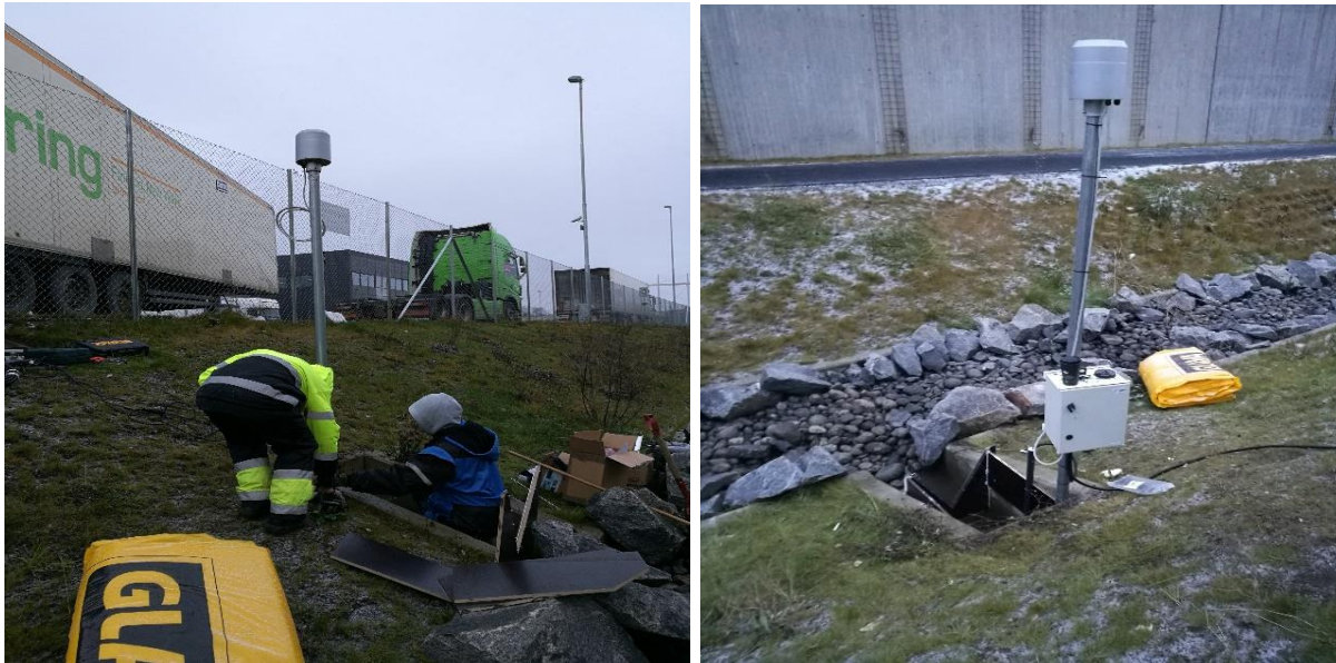
Figur 3.9: Plassering og montering av nedbørmåleren 27. november 2017 med ITAS. Bildet til venstre er tatt under monteringen. Bildet til høyre viser nedbørmåleren ferdig montert.
