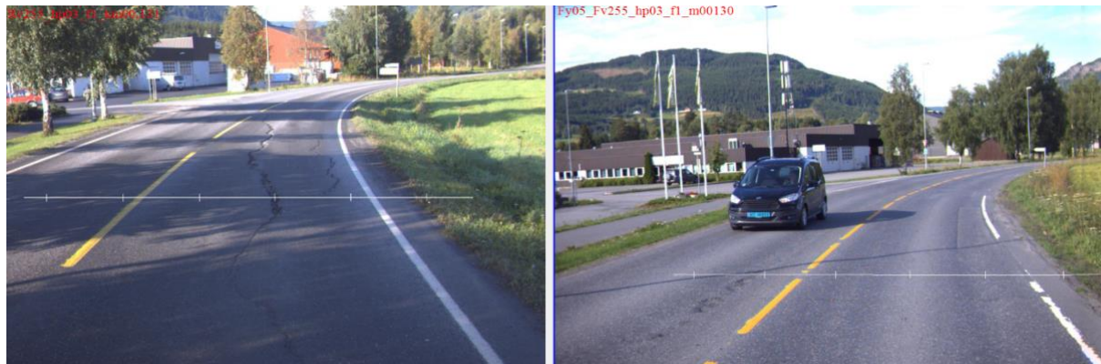
Figur 4-1: Bildet t.v. er det en større telesprekk i 2009, mens på bildet t.h. fra 2017 er det ingen tegn til nye [ViaPhoto]
