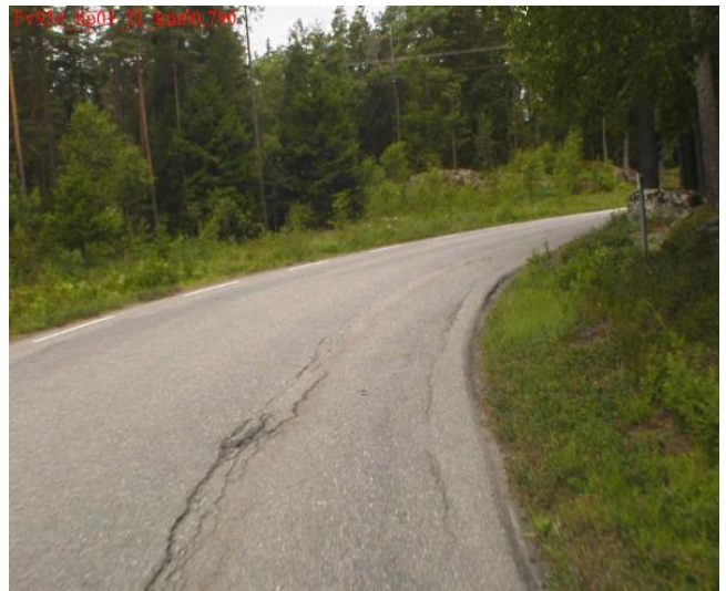
Figur 3-4: : Strekning som holder skadeklasse SK1 [ViaPhoto]
