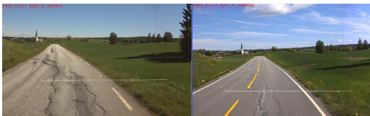
Figur 4-8: Bildet t.v. viser store og lange telesprekker, mens bildet t.h. viser nye mellomstore telesprekker i samme område [ViaPhoto]
