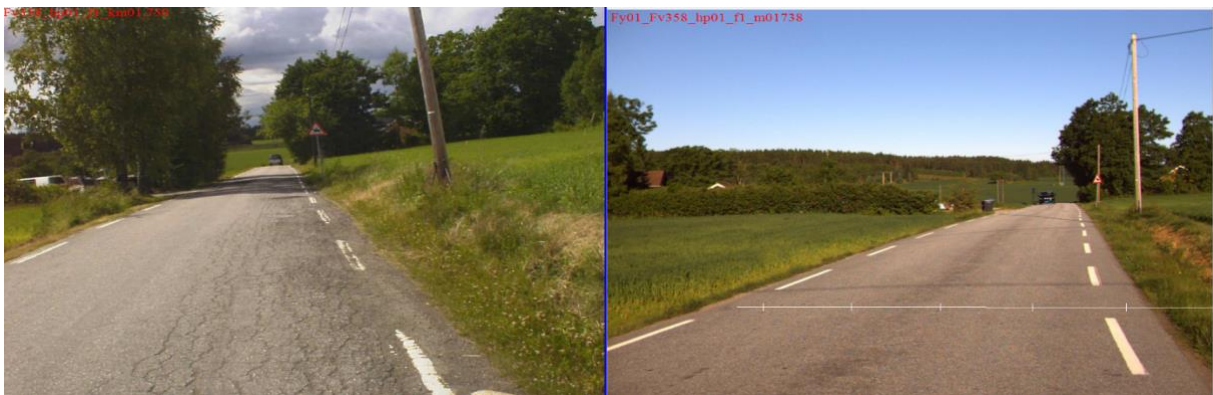
Figur 4-6: Her kan det virke som dreneringsforholdene er utbedret i samme område som det er lagt armering [ViaPhoto]
