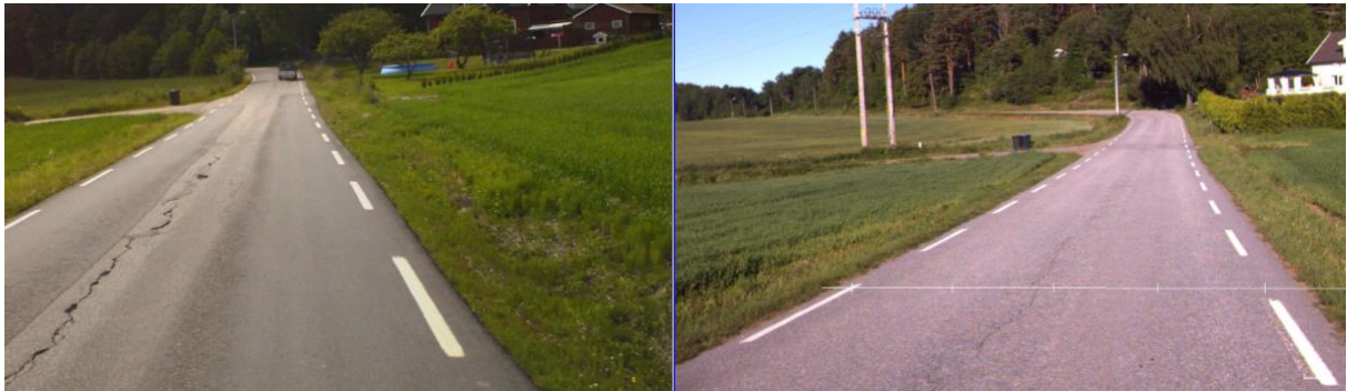
Figur 4-5: Bildet t.v. viser telesprekk fra 2007, bildet t.h. er vegen i 2017 med en svært liten ny sprekk samme sted [ViaPhoto]
