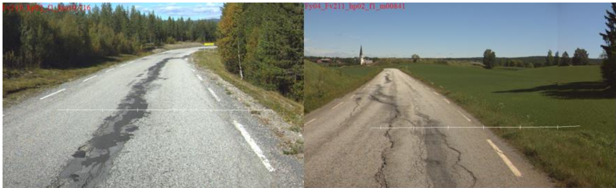
Figur 3-8: Begge strekninger tilhører skadeklasse SK5. [ViaPhoto]
