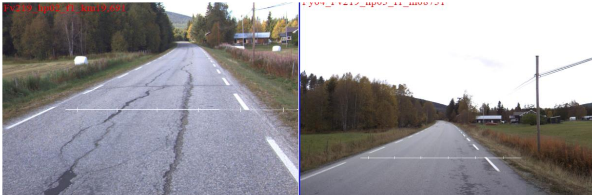
Figur 4-3: Bildet t.v. er fra 2010 før dekkefornyelse. Bildet t.h. er fra 2017 uten nye telesprekker [ViaPhoto]
