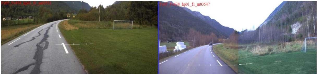
Figur 4-10: Strekningen sliter med store og lange telesprekker vist på bildet t.v.. Bildet t.h. viser ingen nye i 2017 [ViaPhoto]
