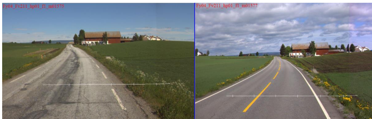
Figur 4-7: Bildet t.v. er fra 2011 og viser store og lange telesprekker, mens bildet t.h. fra 2017 er det ingen tegn på nye [ViaPhoto]
